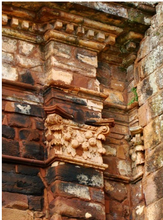
Figura 81 - Materiais e Técnicas construtivas simbolizam uma arquitetura vernacular, econômica, simples, sólida, rústica, híbrida, sustentável – paredes de alvenaria mista de pedras irregulares e cantaria de canga e arenito, argamassa de tabatinga e pilastra com capitel coríntio – São Miguel das Missões – 1735 – RS – Fotografia de Rogério Entringer – 2013
