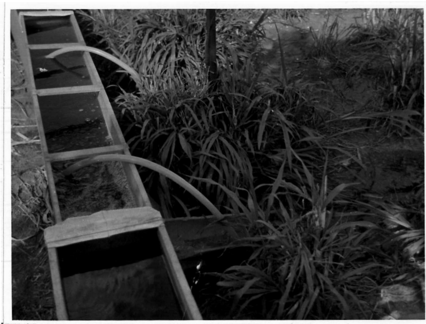
FIG. 3 - Sistema de fornecimento da água aos sulcos de irrigação (sifões plásticos).
