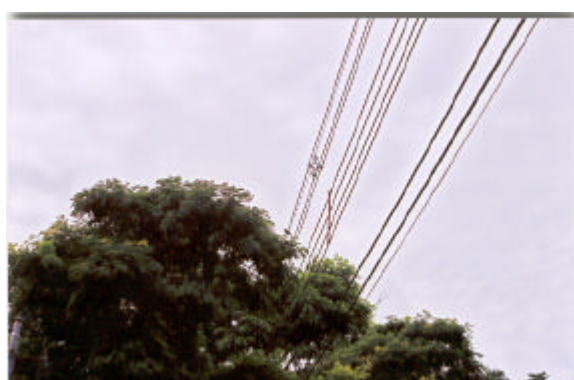
Figura 4 - Espaçadores em rede secundária associado à rede primária compacta, Maringá/PR.
