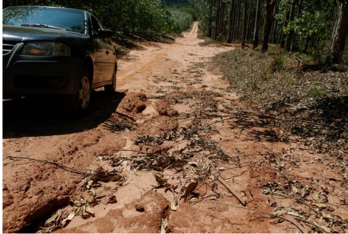
Figura 2.13 – Presença de ravinas e início de processo de voçorocas
