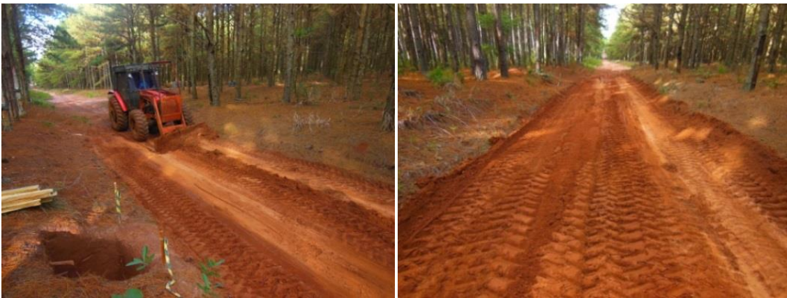
Figura 3.2 - Momento da passagem da lâmina (a) e após a compactação do solo com os pneus dos próprios tratores (b)
