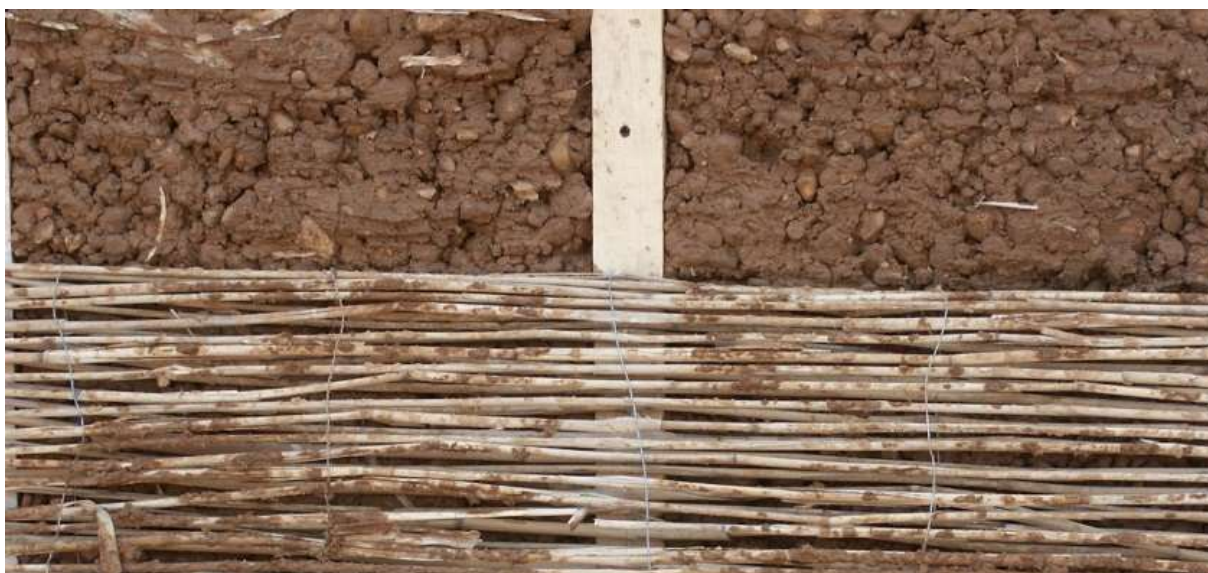
Figura A.3– Construção em Terra Plástica moldada com bambu. Fonte: site Craterre
