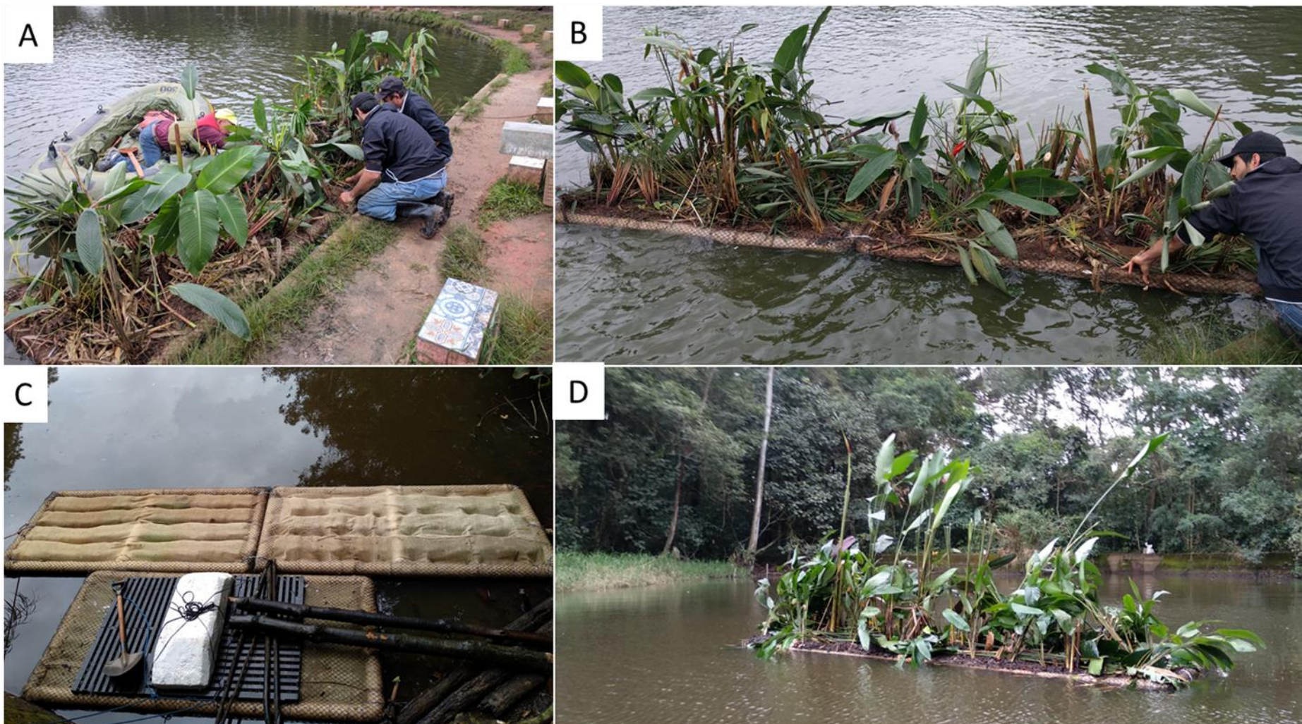
Figura 23 - Alagados flutuantes construídos (AFC) no dia da instalação. A e B apresentam o AFC sendo instalado no lago do Pesqueiro e C e D no lago da Reserva. A) Posicionamento da plataforma dentro da água e ajuste das mudas de plantas plantadas previamente. B) AFC pronto para ser rebocado até local de ancoramento no centro do lago. C) Plataformas posicionadas dentro do lago da Reserva ao lado da balsa e antes de iniciar o plantio da vegetação. D) AFC já ancorado e posicionado no lago da Reserva. Fonte: Elaborado pelo Autor, 2018.
