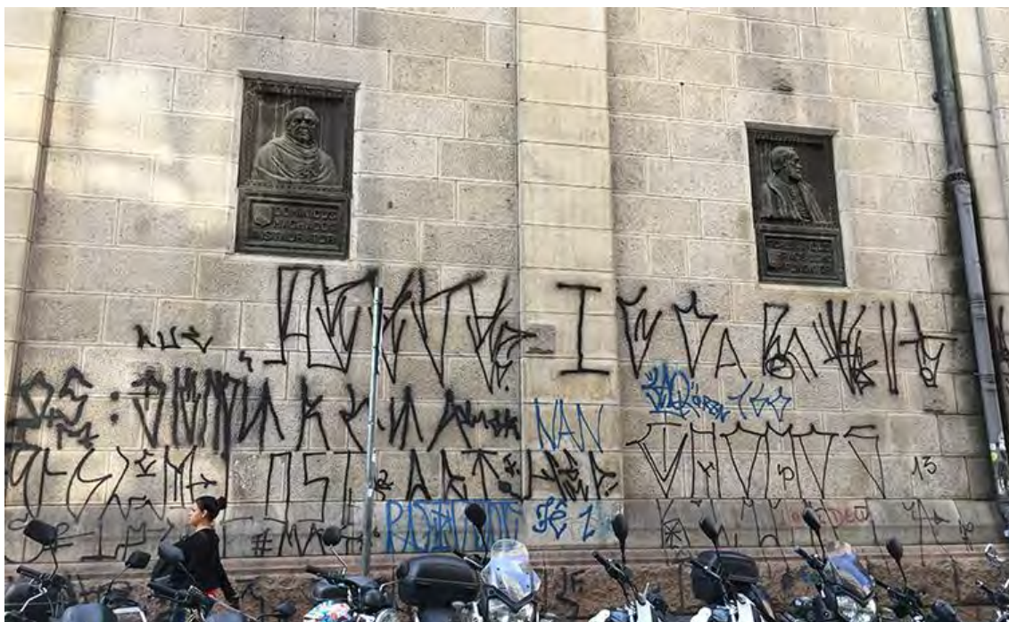
Figura 13. Pichações na fachada lateral do Mosteiro de São Bento, à Rua Florêncio de Abreu. Fonte: Foto tirada pela autora, dezembro de 2019.
