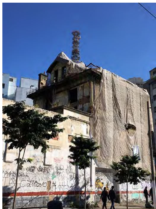
Figura 5. Imóveis à Av. Brigadeiro Luís Antônio, em mau estado de conservação.
