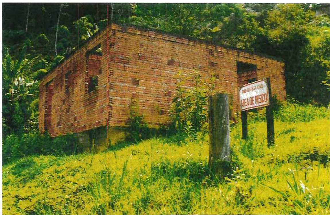
Foto 18. Apesar da placa de aviso de perigo a habitação é construída, Morro do Artur.
