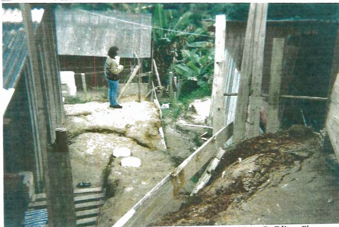
Foto 6. Detalhe do processo de erosão junto a casa - Morro D. Edite - Blumenau. fonte: acervo da autora
