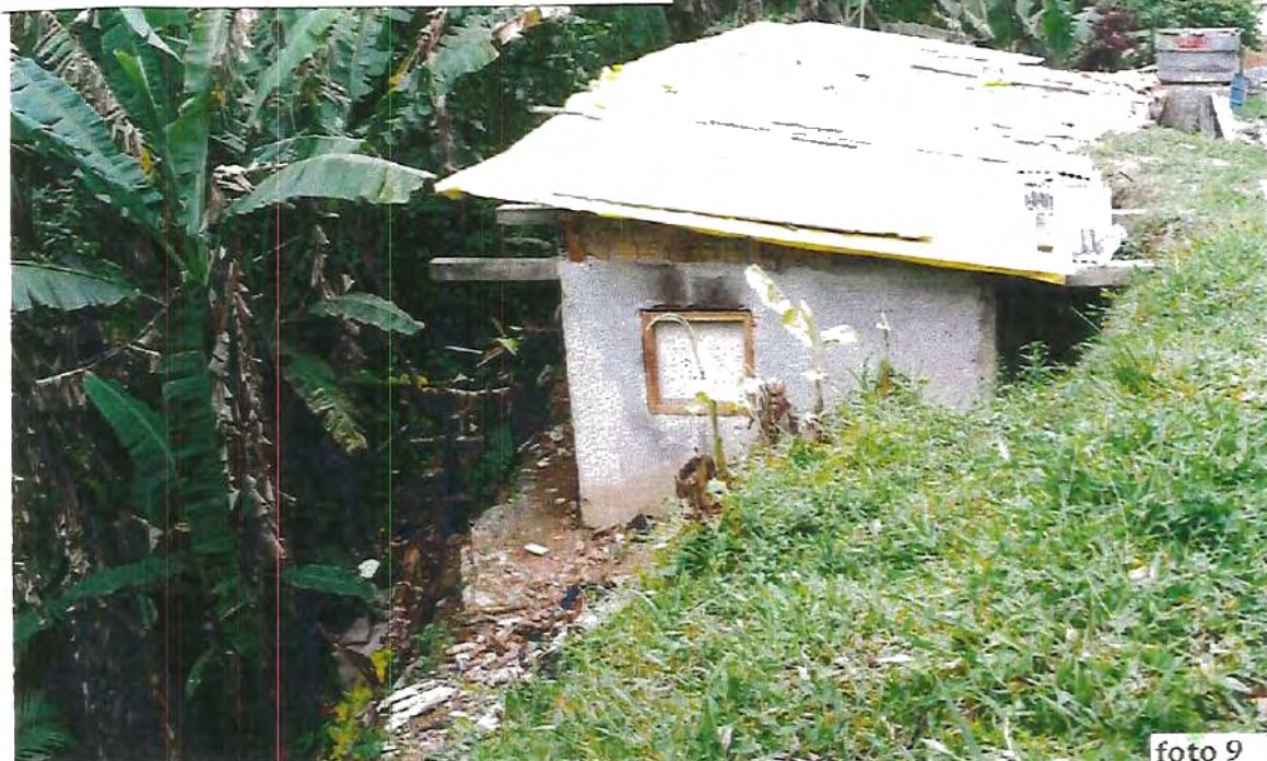
Fotos 7, 8 e 9. Detalhe de esgoto a céu aberto e habitação em local de grande instabilidade - Morro da Pedreira- Bumenau.
