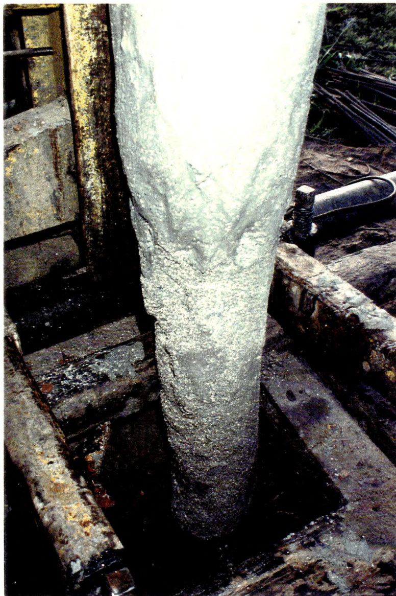
FIGURA 3.12 - Detalhe do afunilamento do fuste da estaca extraída, mostrada na Figura 3.10.
