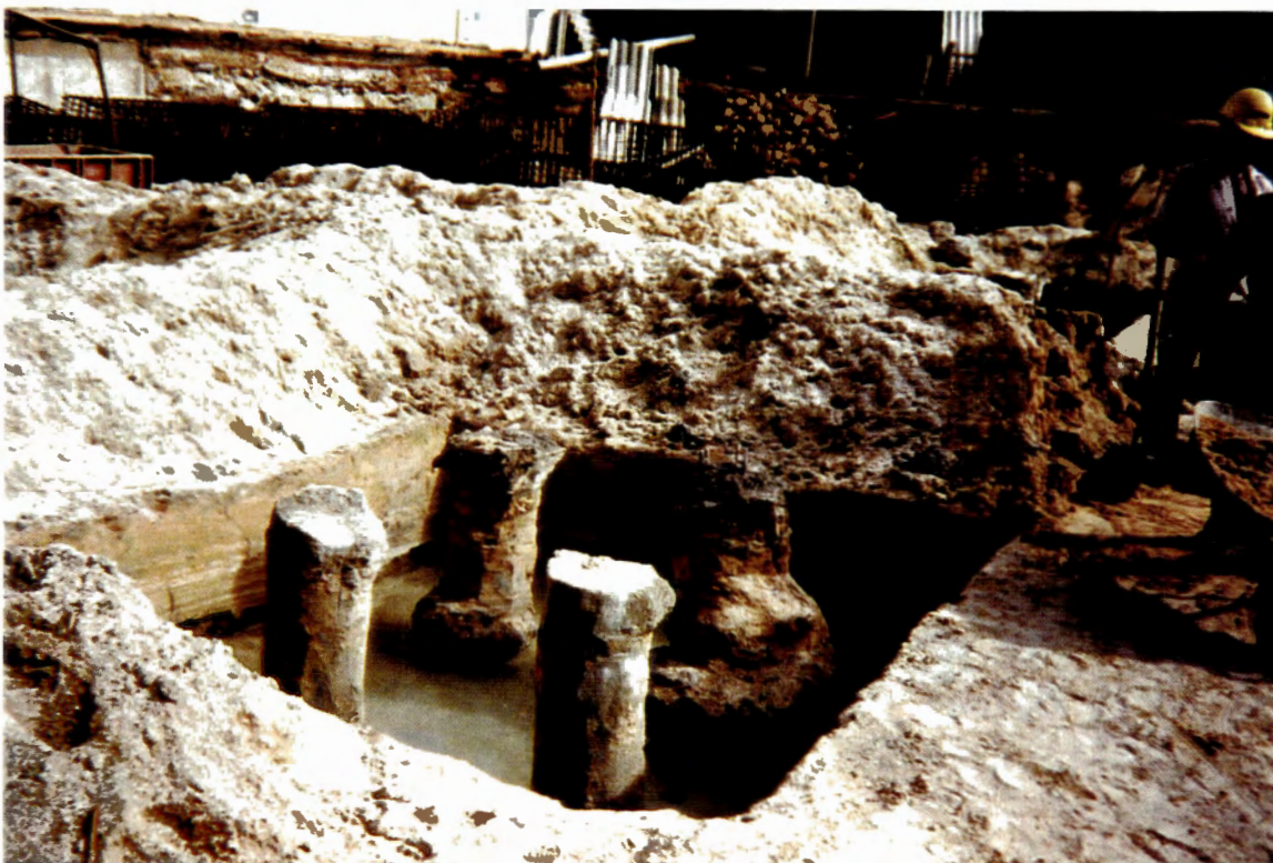
FIGURA 3.14 - Detalhe das formações naturais de “placas”, “joelhos”, no fuste de estacas Rotativas-Injetadas.
