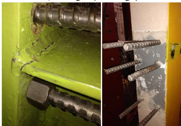
b) Ruptura da solda
