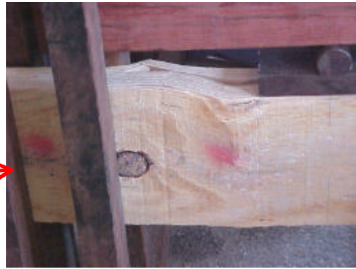
Figura 118 – Detalhe do esmagamento das fibras.
