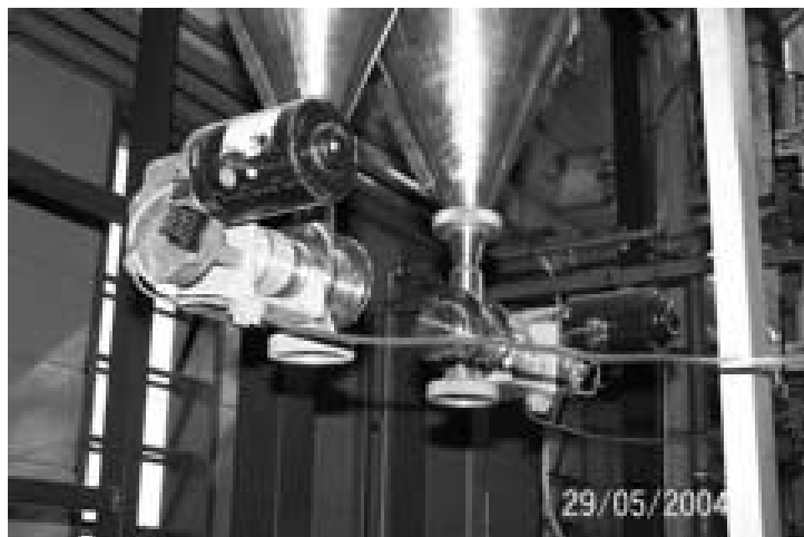
Figura 3.14 – válvulas montadas e acopladas nos respectivos silos de armazenamento de carvão e de calcário.
