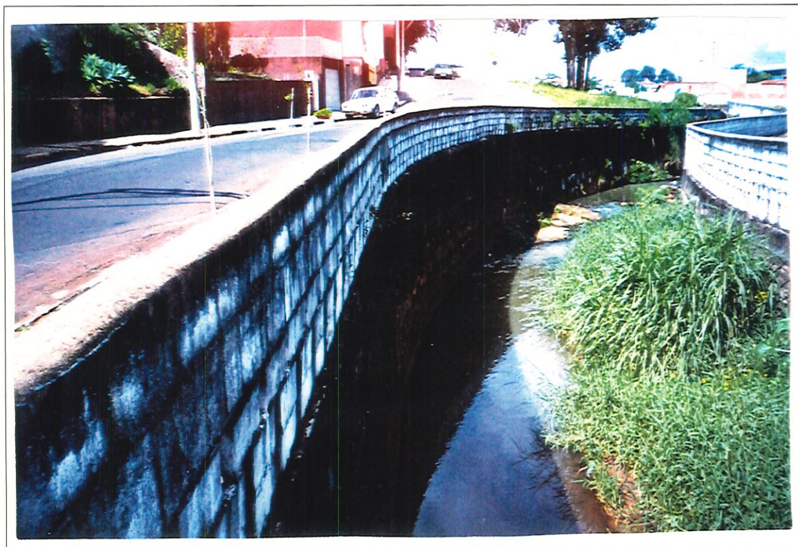
Foto 1: Assoreamento do trecho canalizado do Córrego do Gregório, onde pode ser identificado a granulometria fina do material depositado, indicando constituir-se em material mobilizado da própria bacia.
