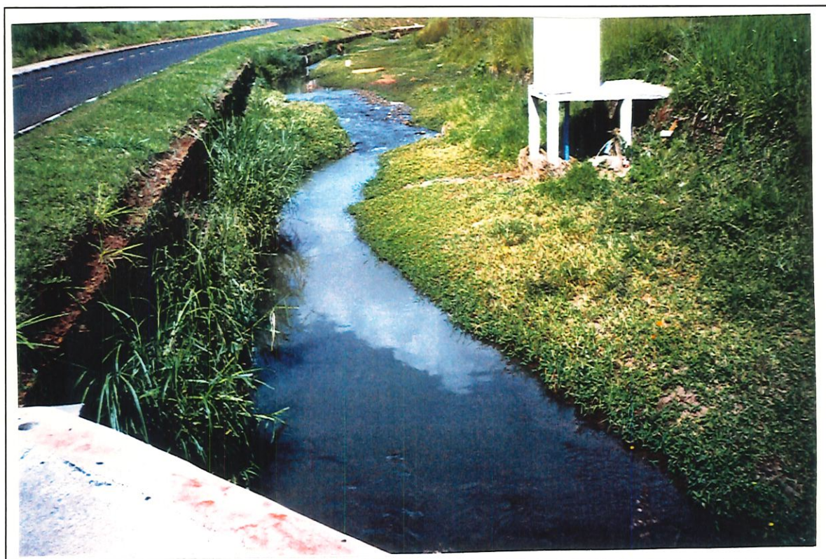
Foto 9: Aspecto do fluxo do canal do Córrego do Gregório, destacando-se, no lado direito um material de antigo assoreamento provocando o estreitamento do canal. (Foto da Autora - 1999).
