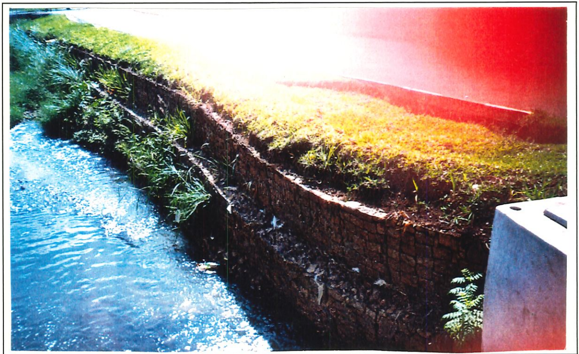
Foto 6: Abaulamento de obras de contenção causado pela pressão de fluxos de sedimentos vinculados a dinâmica pluvial. (Foto da Autora - 1999).
