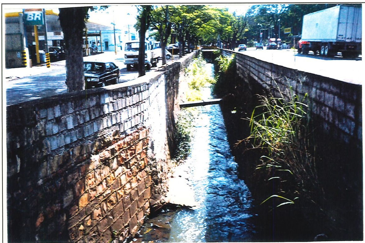
Foto 7: Abaulamento de obras de contenção em trechos onde não se observa a exposição de sedimentos, indicando a ação predominante do escoamento subsuperficial. (Foto da Autora - 1999)
