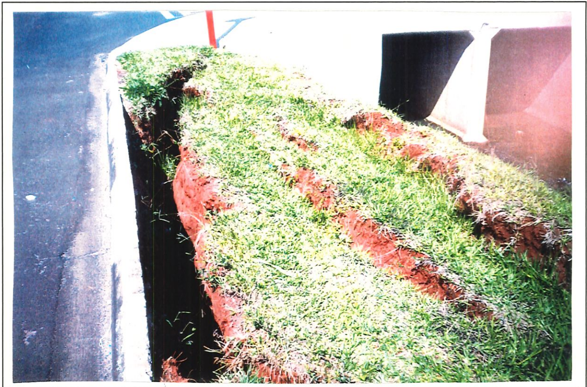
Foto 5: Forma erosiva decorrente da ação do escoamento pluvial e subsuperficial. (Foto da Autora - 1999).
