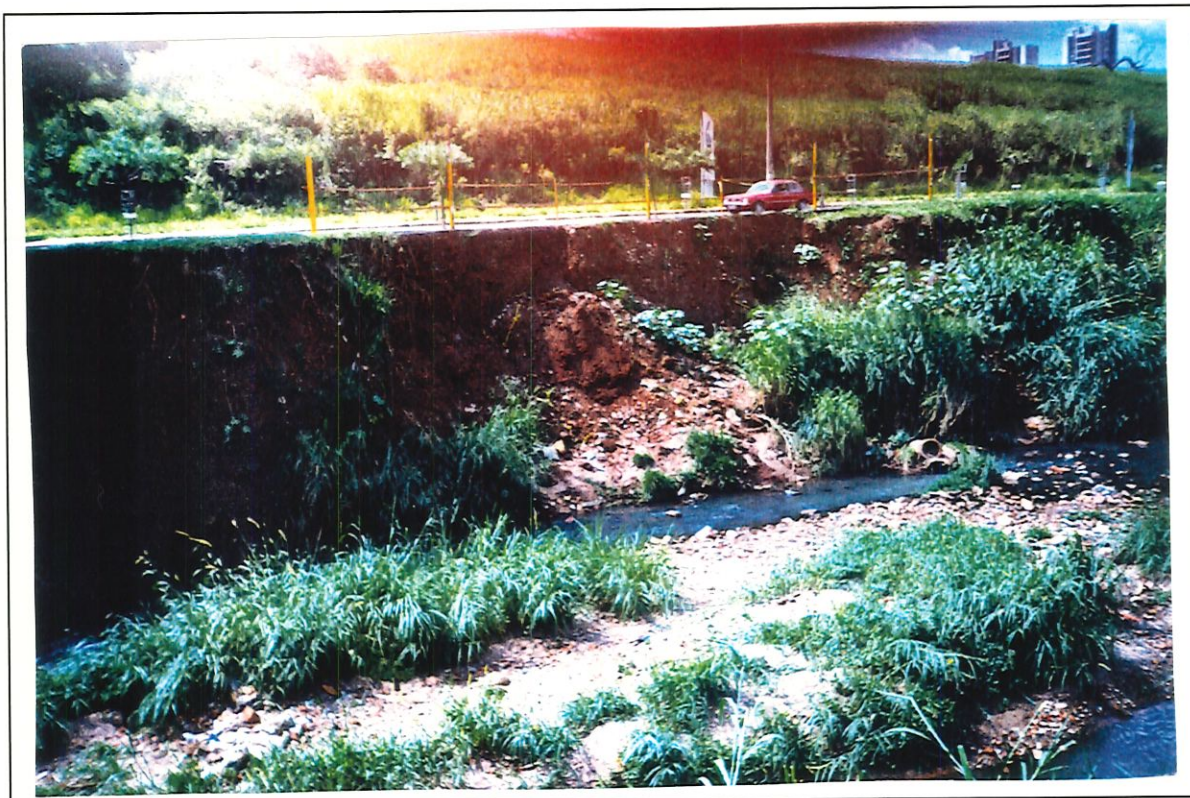
Foto 10: Aspecto do assoreamento do canal do Córrego do Gregório por material utilizado em obras de contenção de erosão. ( Foto da Autora - 1999)
