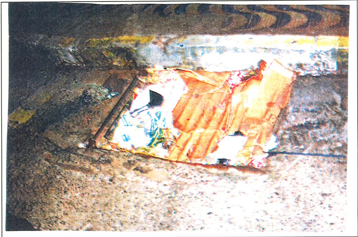
Foto 14: Deficiências na coleta de lixo urbano impedem a funcionalidade dos bueiros. (Foto da Autora - 1999).
