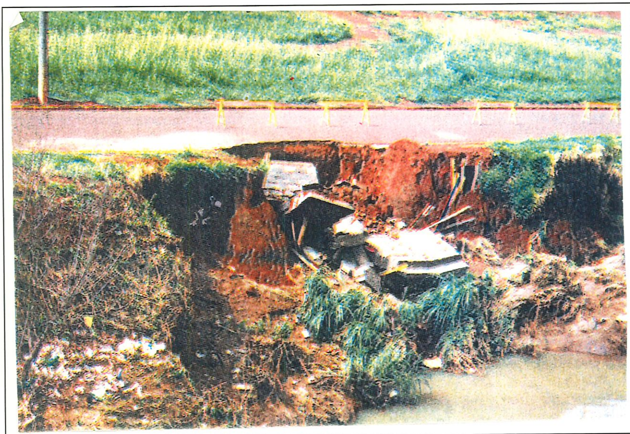
Foto 8 : Desbarrancamento do talude em setor não canalizado do Córrego do Gregório, por ação de processos de escoamento superficial e subsuperficial.
