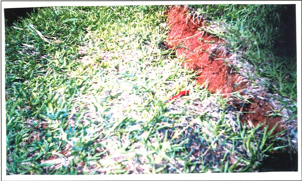
Foto 4: Ruptura topográfica indicativa do abatimento de uma parte do talude em relação a outra.
