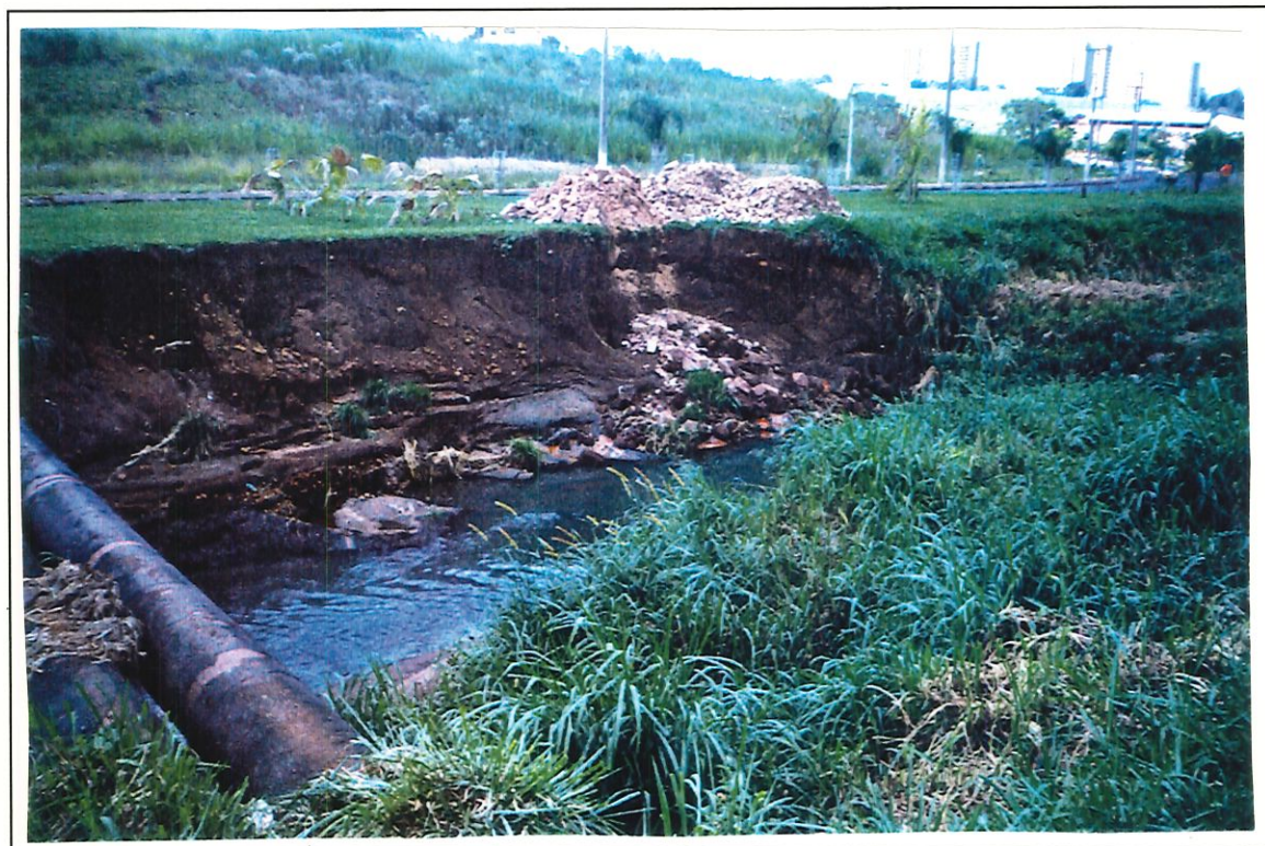
Foto 15: O inadequado preenchimento de áreas erodidas do talude do Córrego do Gregório. (Foto da Autora -1999).
