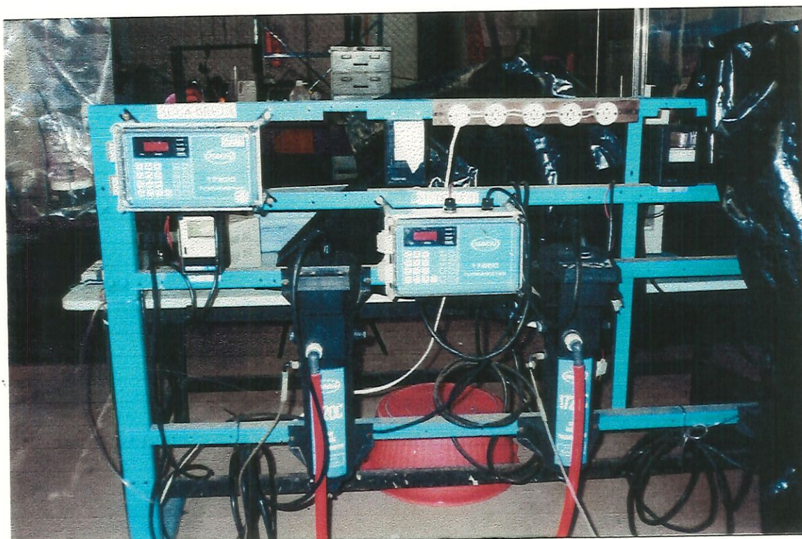
FIGURA 4.11- TURBIDÍMETROS DE ESCOAMENTO CONTÍNUO PARA MONITORAMENTO DA ÁGUA BRUTA E DO EFLUENTE DO FRD
