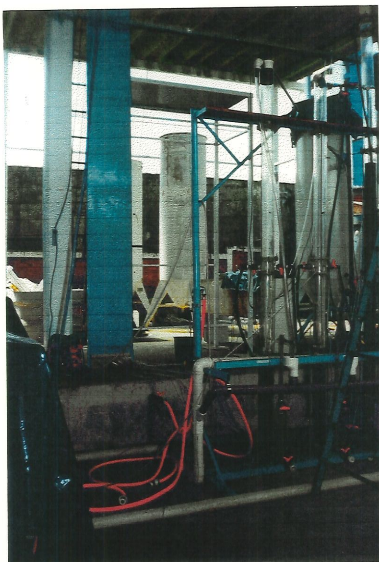
FIGURA 4.9 – VISTA FRONTAL DO FILTRO RÁPIDO DESCENDENTE (FRD)
