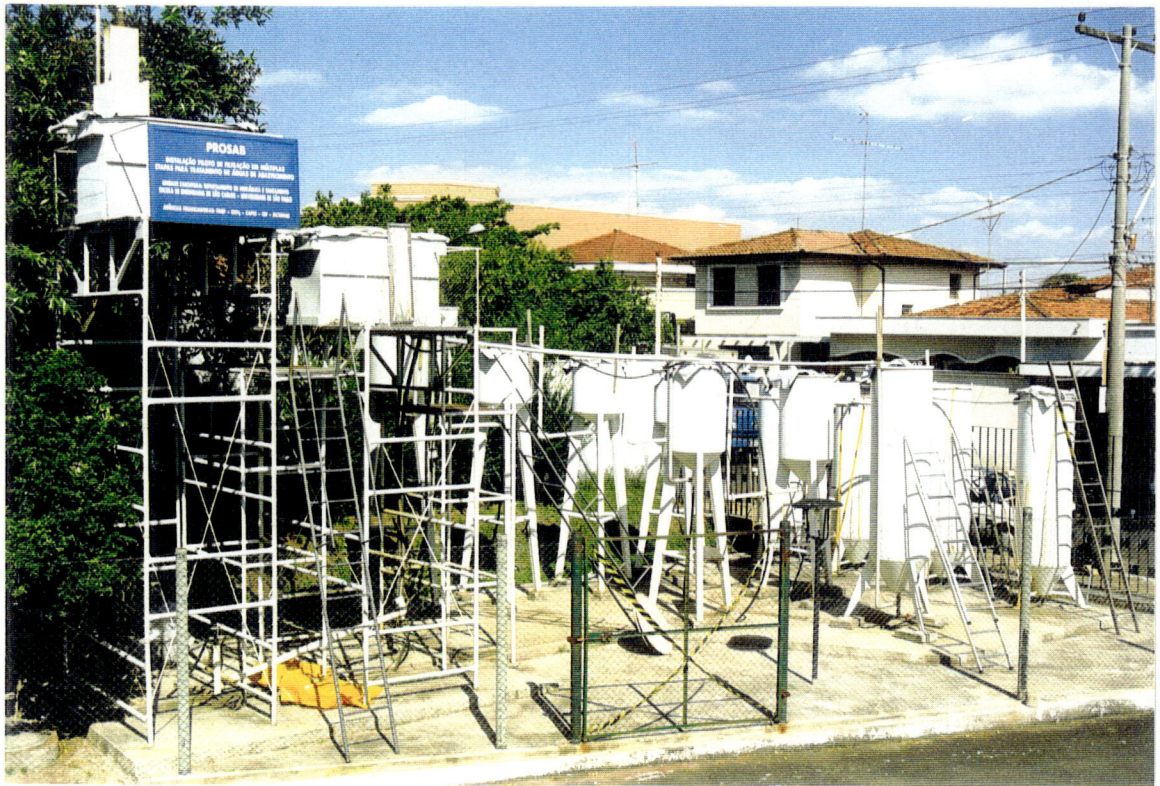
FIGURA 4.2 – Vista geral da instalação piloto
