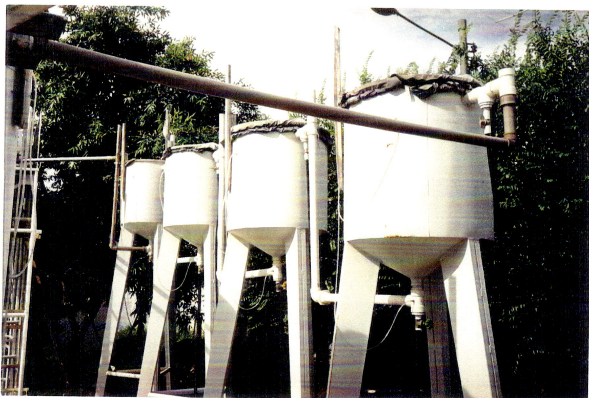
FIGURA 4.6 Detalhes das quatro unidades de pré-filtros em pedregulho com escoamento ascendente que constituem a linha 01.
