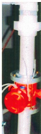
Figura-Foto F - Medidor eletromagnético de vazão instalado
