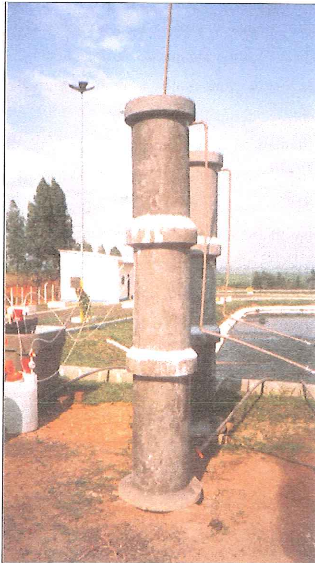
FIGURA 42 - Tanques anaeróbios das duas linhas da unidade piloto
