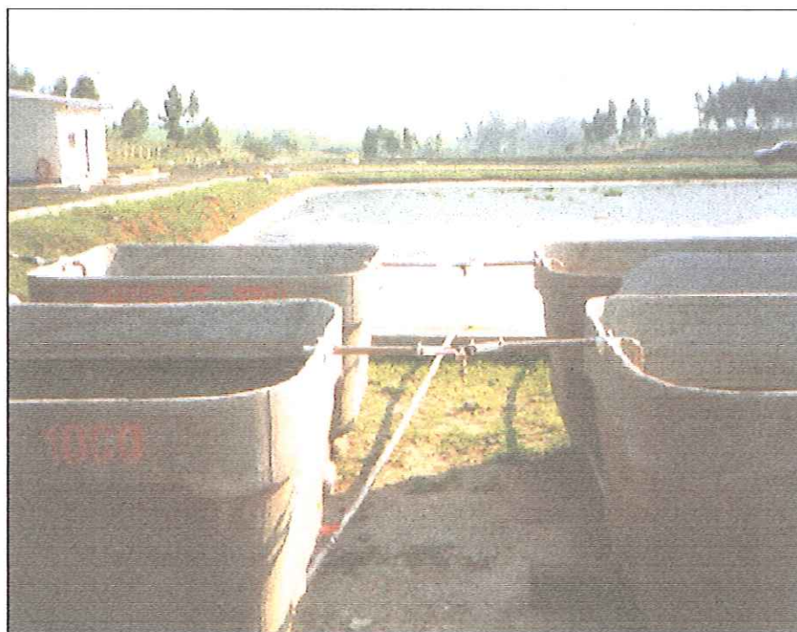
FIGURA 43 - Tanques facultativos das duas linhas da unidade piloto
