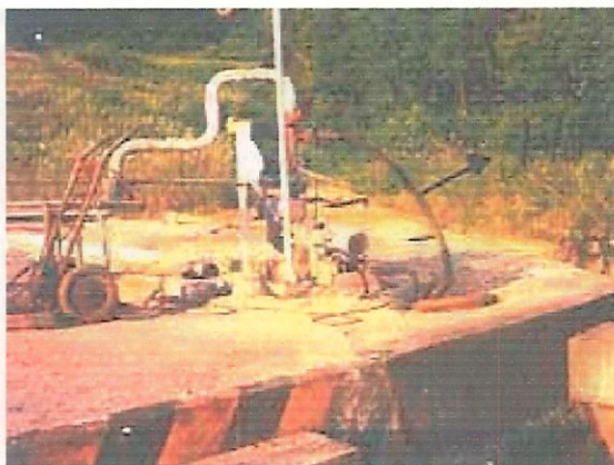
Foto 6 - Bomba J- 2320, constantemente parada, ficou 1 ano fora de operação. Quando chove, é insuficiente para a drenagem, transbordando para o rio.
