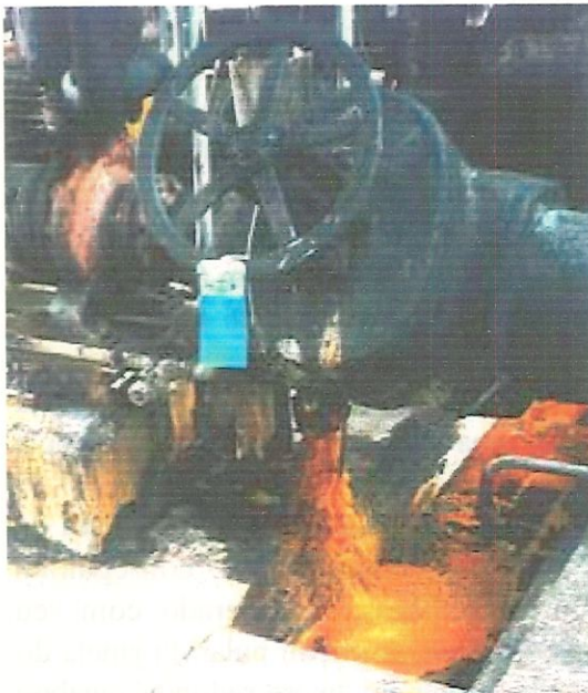
Foto 2 - Vazamento da bomba J-1211 A/B um verdadeiro coquetel de substâncias organocloradas
