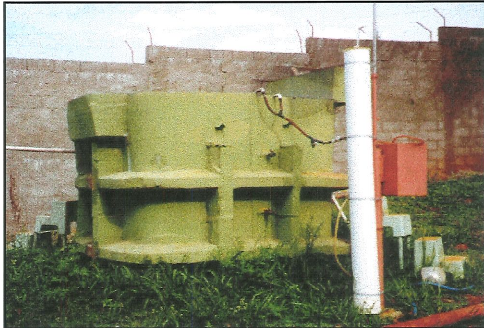
Figura 4.2- Reator Anaeróbio de Manta de Lodo utilizado no trabalho.
