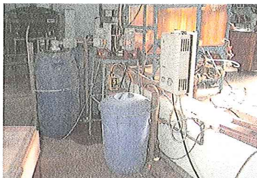
FIGURA 4.7 – Fotografia das bombas dosadoras e galões de produtos químicos com medidor volumétrico
