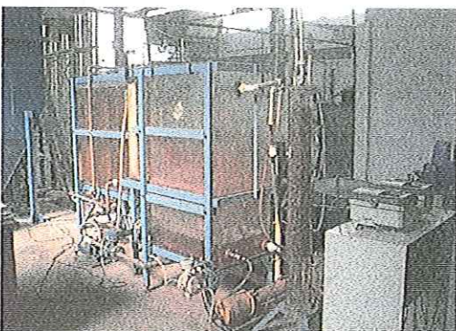
FIGURA 4.8 – Fotografia da instalação da bomba de recalque e da câmara de saturação
