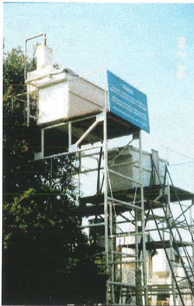
FIGURA 4.9 – Foto dos pré-filtros dinâmicos
