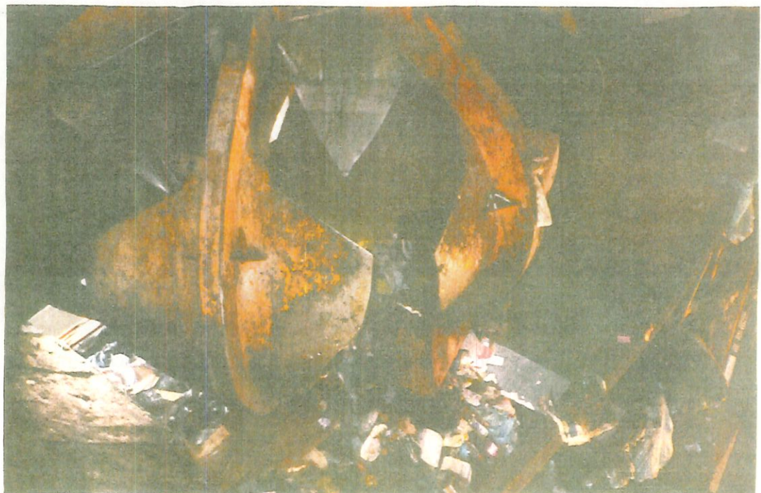
FIGURA 22 - Estação de transferência Caju (usina): vista superior da garra carregando uma carreta de transporte.
