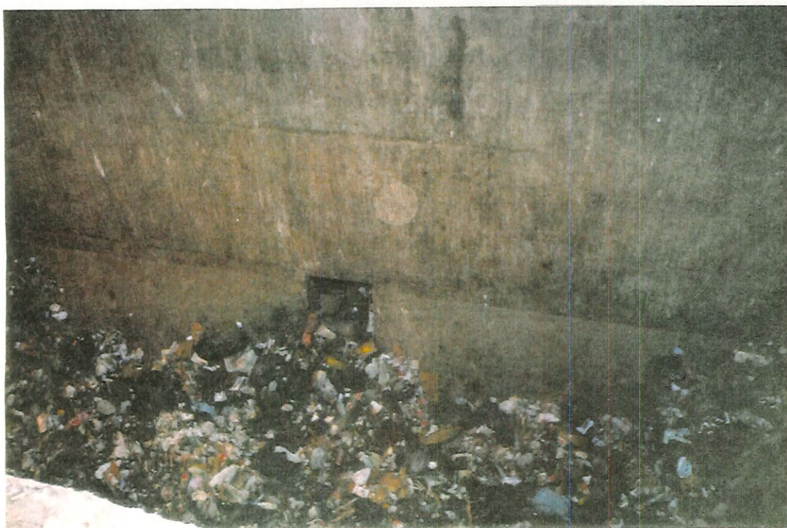
FIGURA 23 - Estação de transferência Caju (usina): ralo para escoamento do chorume produzido no fosso.
