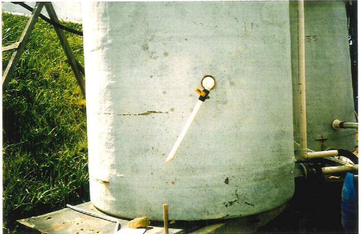
FIGURA A19 - Foto: Dispositivo para coleta do Esgoto Decantado.
