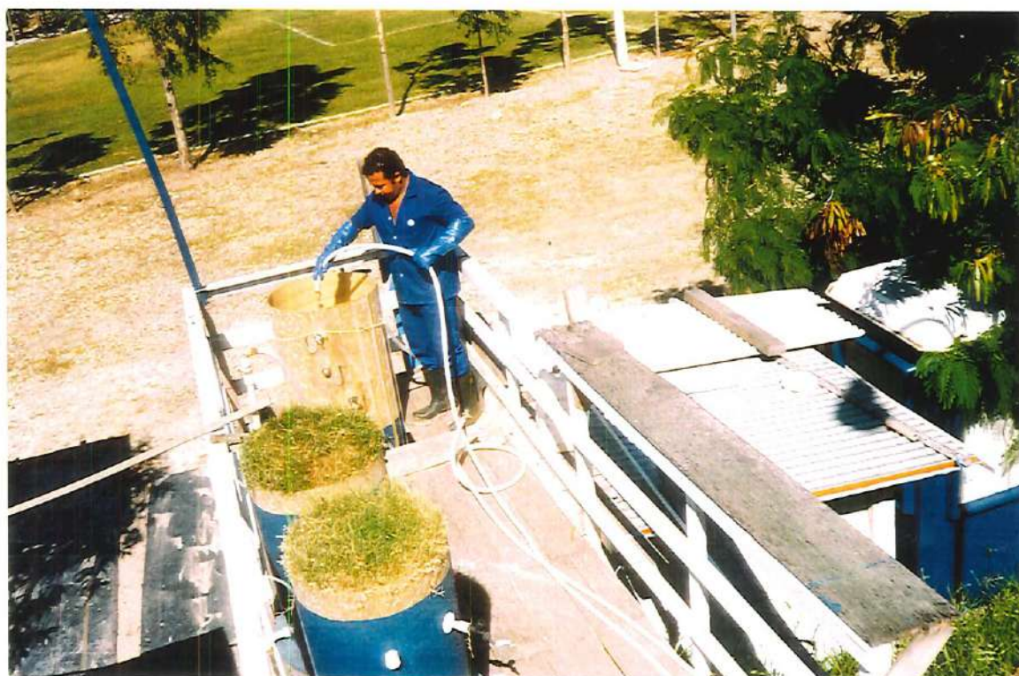
FIGURA A22 - Foto: Aplicação do Esgoto Decantado sobre o distribuidor do TDV através de movimentos circulares.
