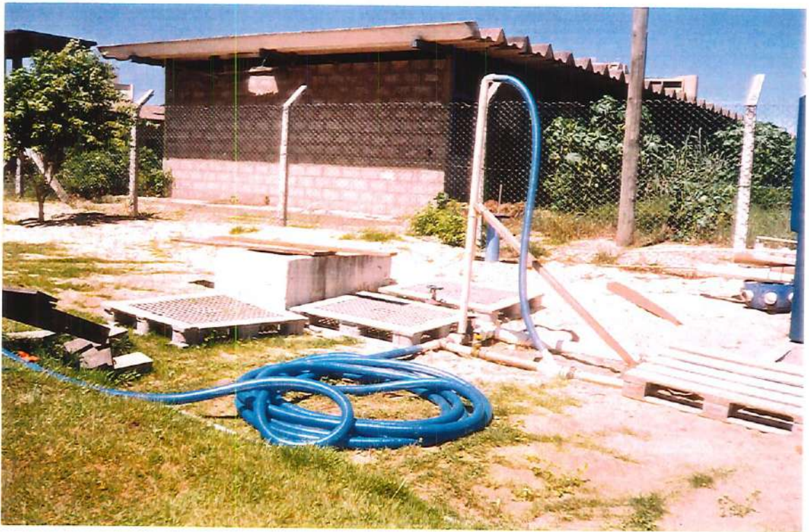
FIGURA A34 - Foto: Caixa de chegada do esgoto na BIE. À direita: registros de chegada e da descarga da rede. Ao fundo: o poço de monitoramento PH.
