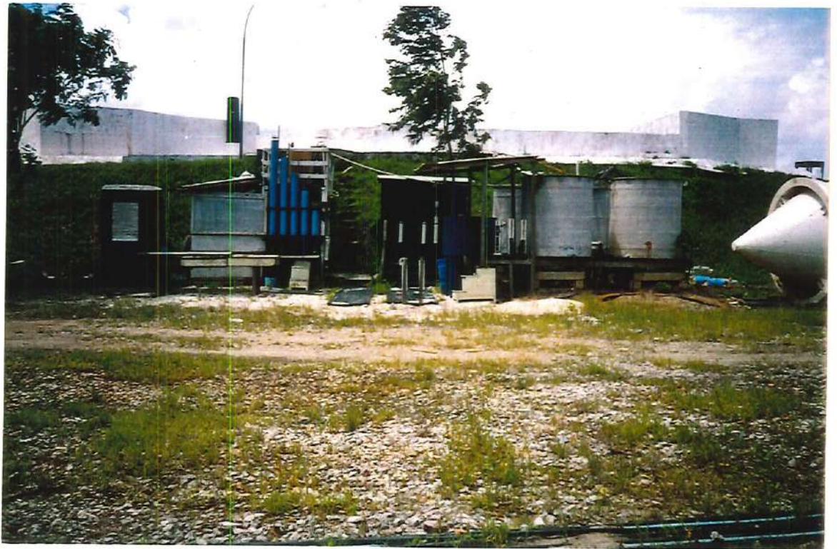
FIGURA A13 - Foto: Vista geral da frente do Sistema de Laboratório.
