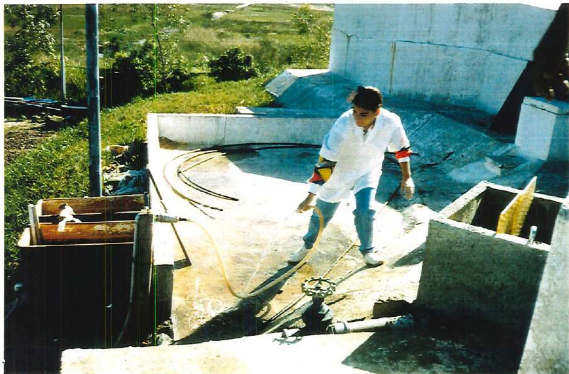
FIGURA A4 - Foto: À esquerda: decantadores. À direita: caixa de tomada do Esgoto Bruto.
