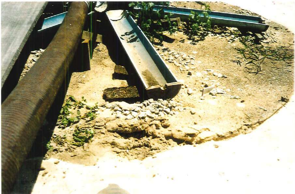
FIGURA A32 - Foto: Camada colmatante na BIE de aproximadamente 5cm.
