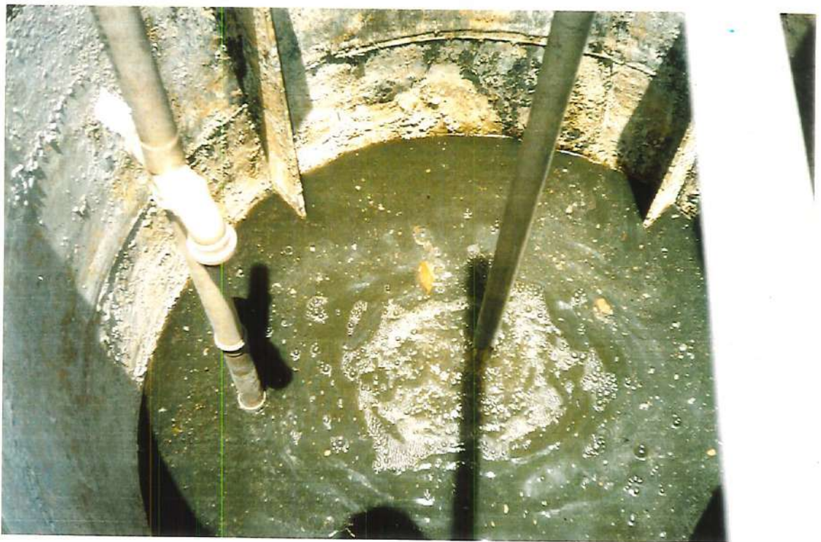
FIGURA A18 - Foto: Tanque de decantação de entrada (limpo). Dispositivos de entrada e de passagem entre tanques através dos “joelhos”.
