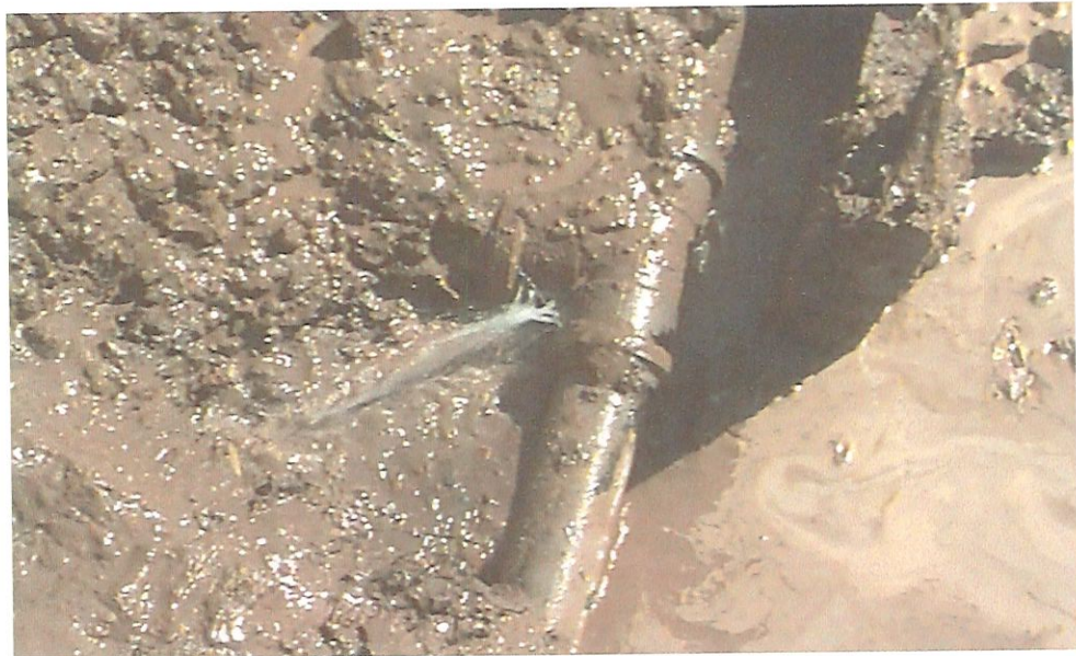
FIGURA 4.5 – Vazamento na rede do Jardim Monte Carlo (Tê de 2”).
