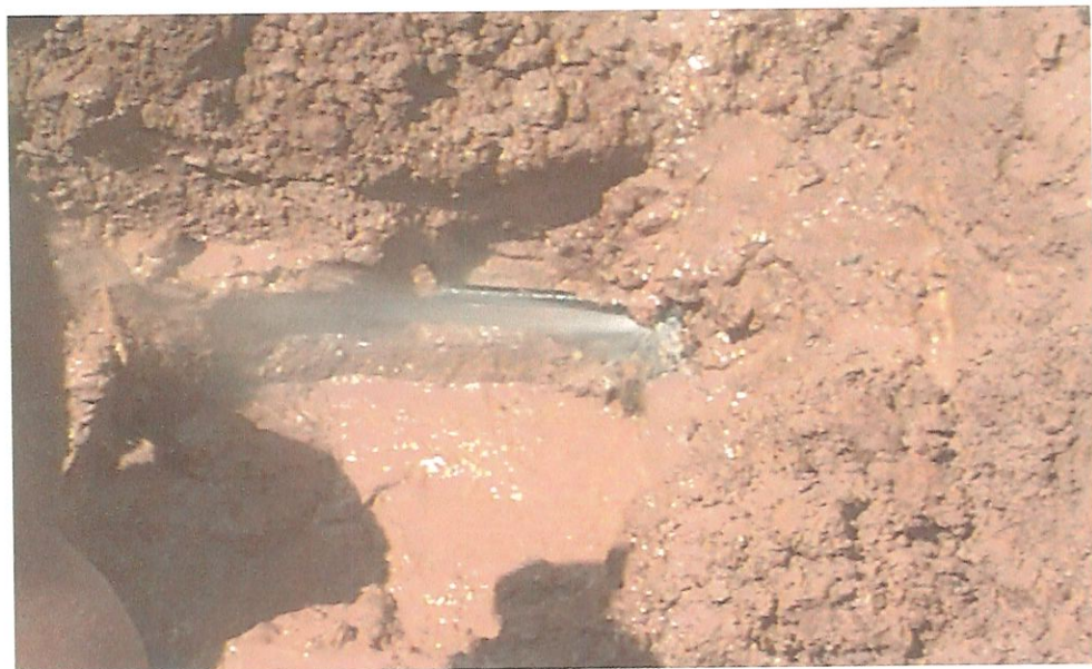
FIGURA 4.6 – Vazamento em ramal predial do Jardim Monte Carlo.
