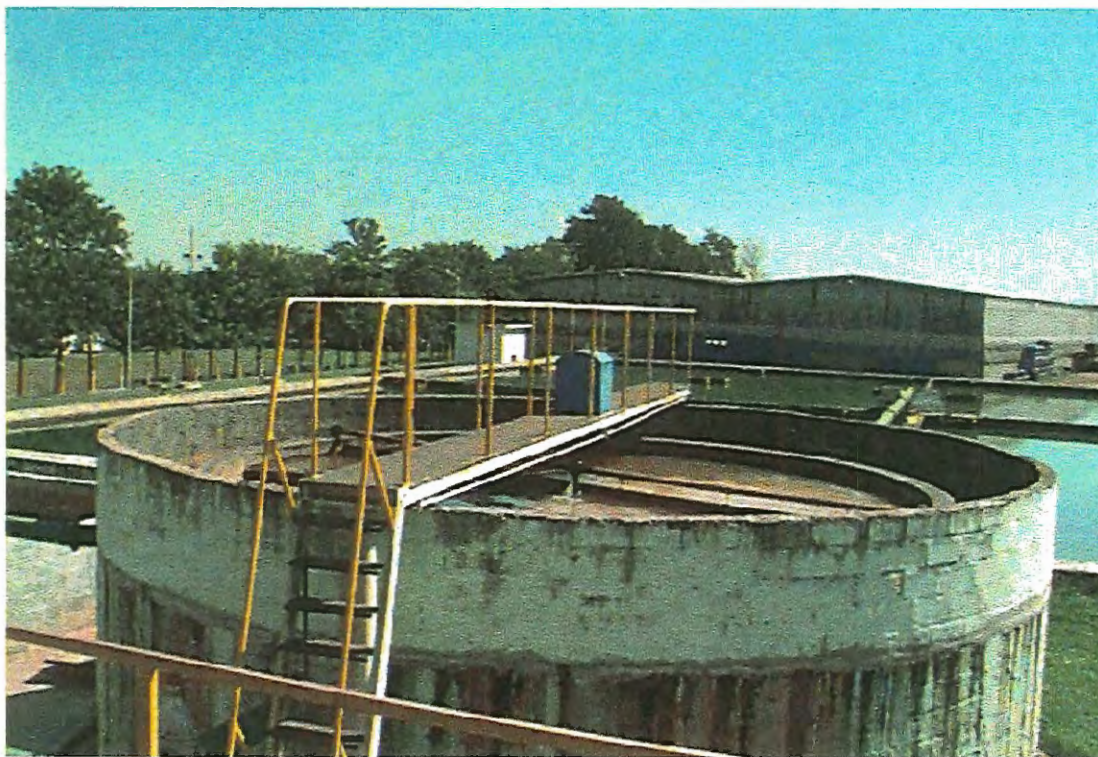
A – Tratamento Físico-Químico: Tanque de Flotação
