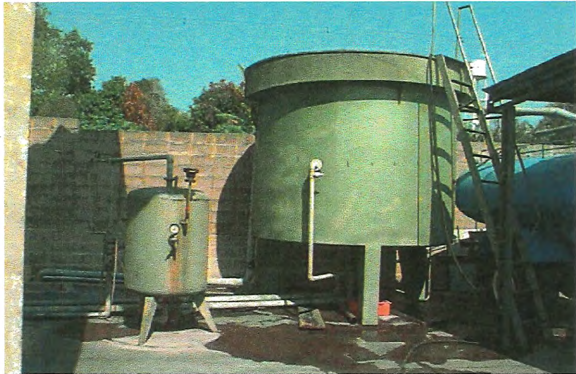
A - Unidade de Flotação: Flotador e Câmara de Saturação
