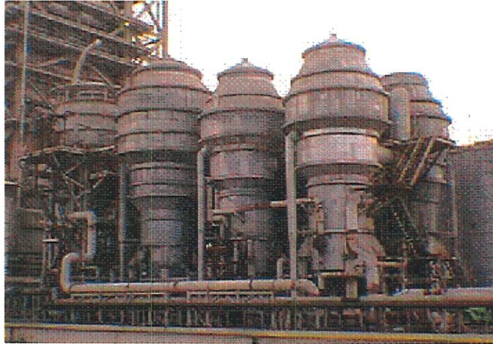
Figura 3.13. Vista do sistema de evaporação da Jari Celulose.
