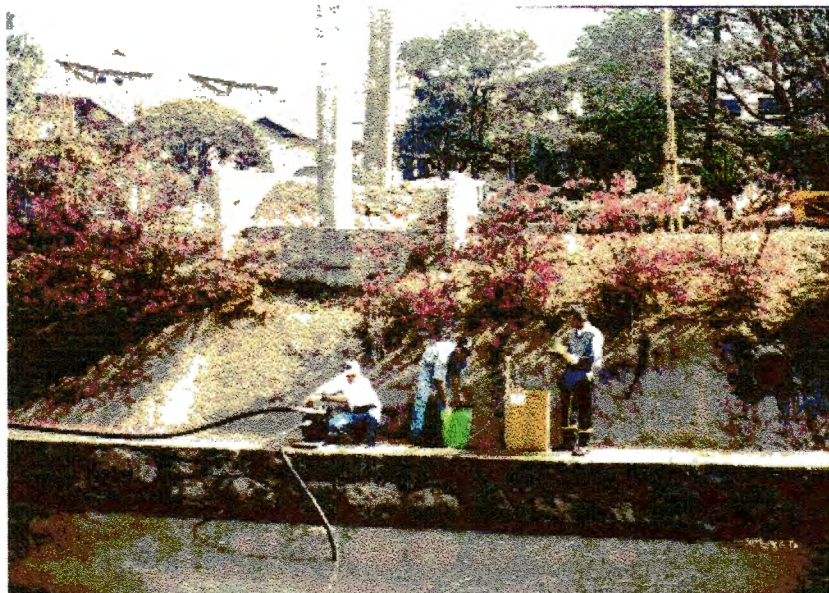
Figura 5.17 - Equipamento de injeção do traçador gasoso sendo preparado para o teste de 30/08/94 no Ribeirão de Caldas.
