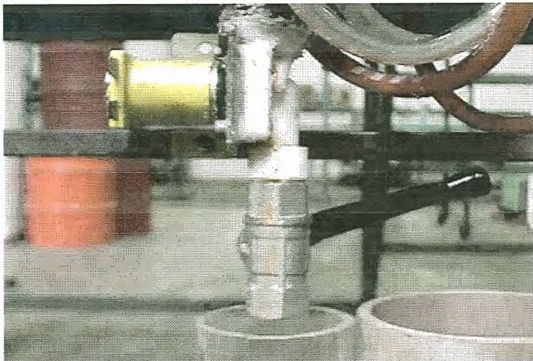
FIGURA 18 – Válvula elétrica e Registro Tipo Esfera na base do poço de drenagem
