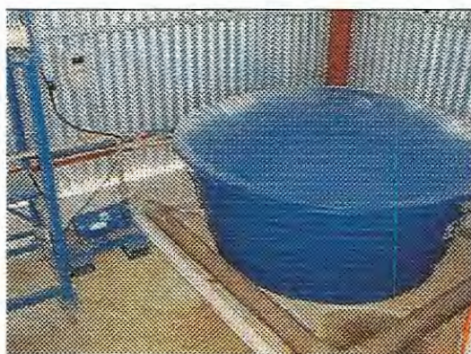
FIGURA 4.5: Fotografia da caixa armazenadora de esgoto e da bomba MARK XD1 utilizada.
