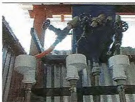
FIGURA 4.6: Fotografia da caixa de distribuição e registros de agulha utilizados no controle de vazão de entrada dos filtros.
