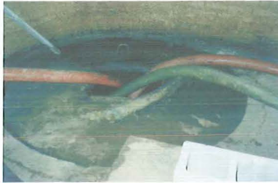
Figura 9 - Tanque de concreto - Chorume da parte antiga do aterro
