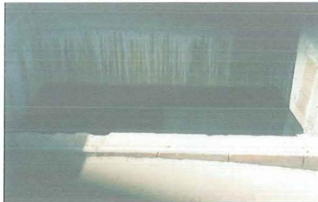
Figura 7 - Tanque de concreto - Líquido percolado proveniente da parte nova do aterro.
