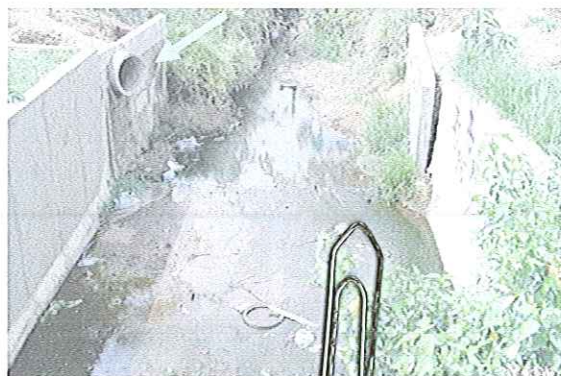
Figura 7.9: Afluente do Gregório canalizado e sem escoamento. Foto: Alves (2008).
