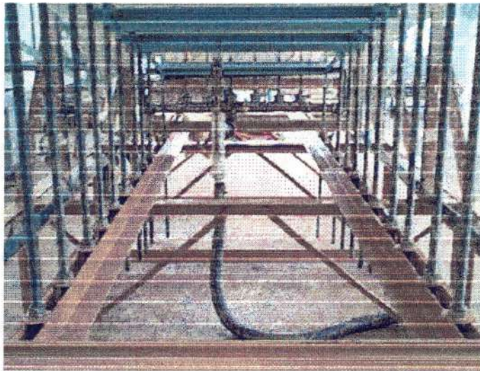
FIGURA D.9 – Detalhe dos parafusos de sustentação, sistema de drenagem do reservatório, trilhos de deslocamento e base de apoio
