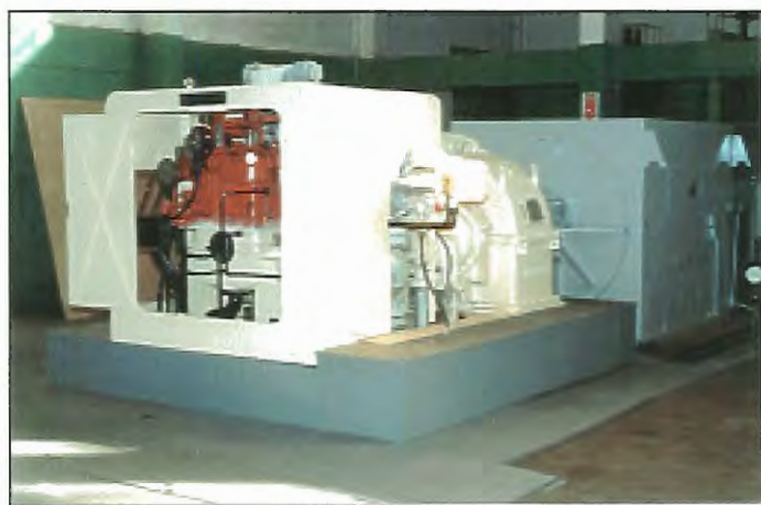
Figura 21: Gerador de energia
