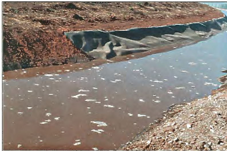
Figura 09: Canal de vinhaça com e sem impermeabilização
