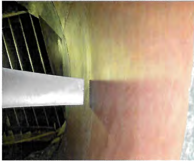
Figura 4.10: Espaçamento, pouco menor que 1 cm, entre a pá do ventilador do túnel e a parede do túnel.
