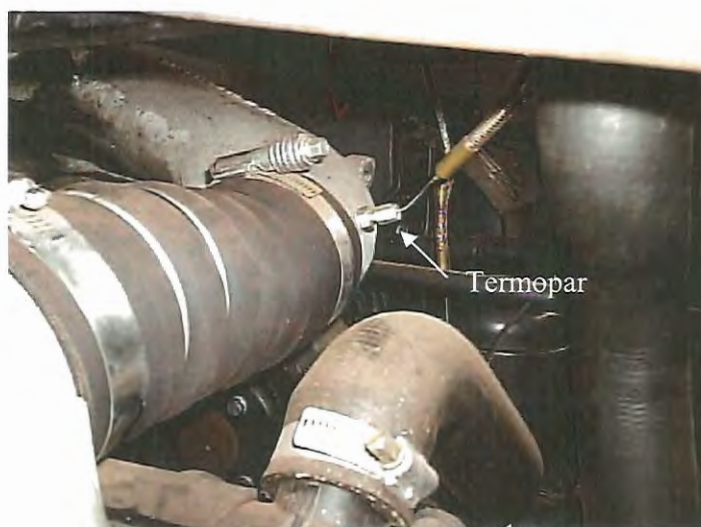
Figura 45. Termopar instalado na entrada do intercooler
