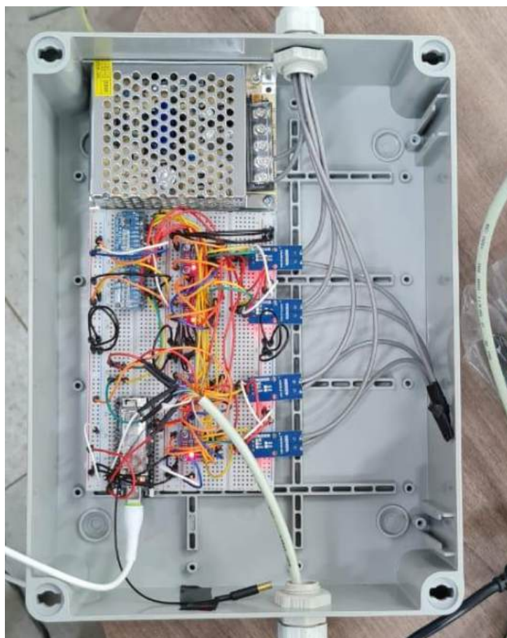
Figura 97 – Protótipo do módulo transmissor do monitor de condição de isolamento proposto
