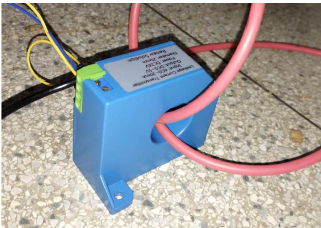
Figura 106 – Detalhe da conexão do sensor de corrente para medição da corrente de fuga do isolador
