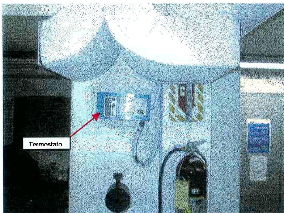
Foto 10: Lateral do duto de insuflação, com vista do termostato e controles de liga/desliga do compressor e do ventilador.
