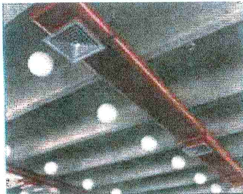
Foto 5: Dutos de distribuição de ar em posição compatível com a estrutura da edificação e com o sistema de iluminação artificial.
