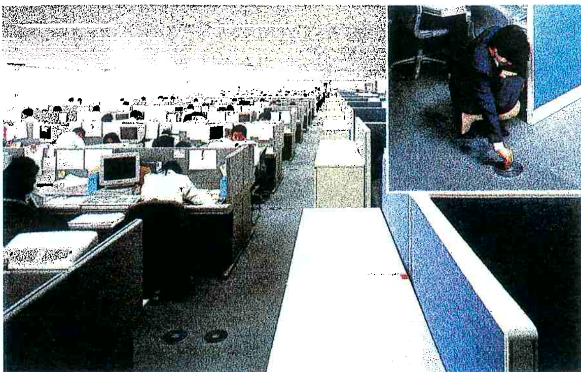
Foto 6: Vista de um escritório com insuflação de ar pelo piso.
