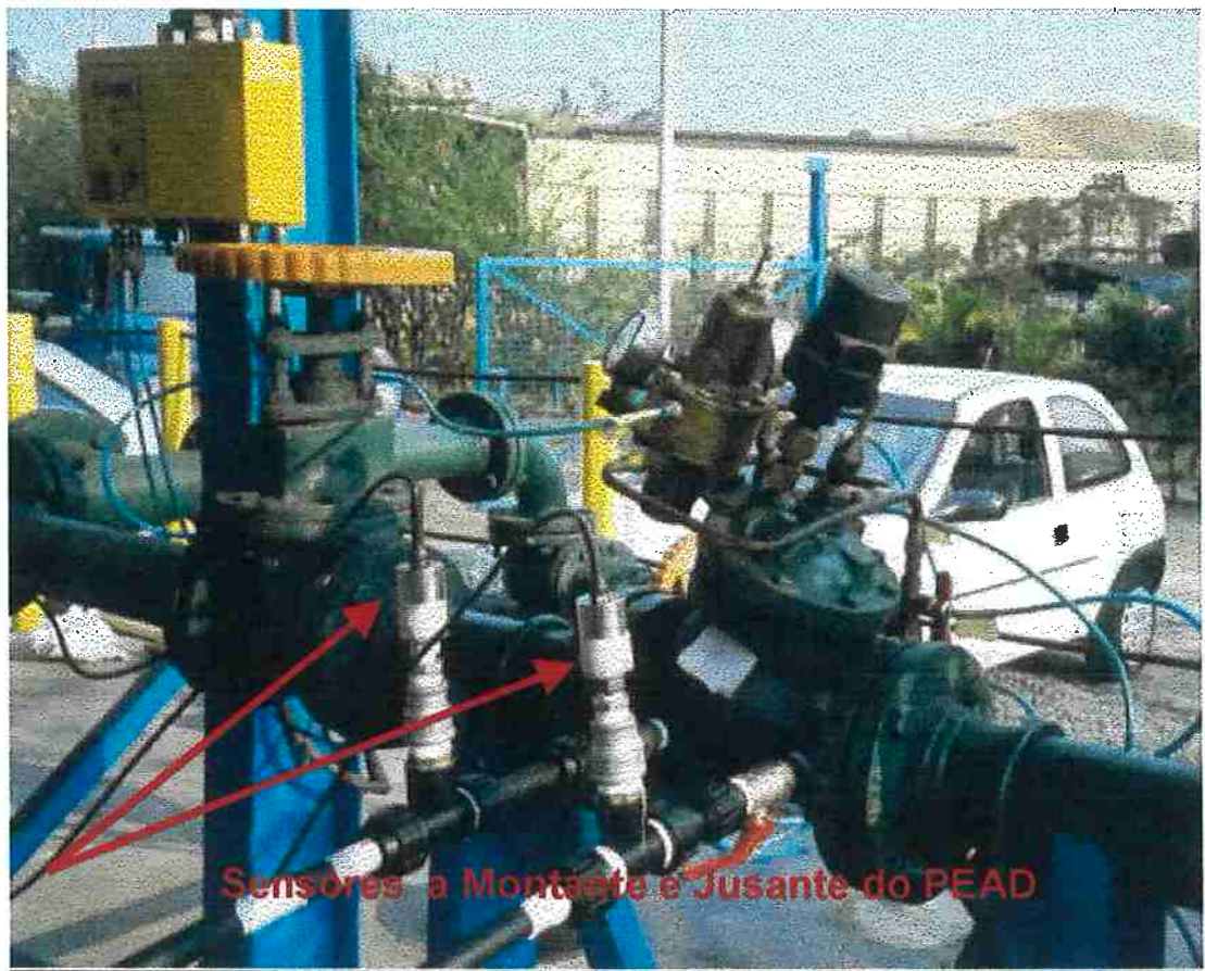
Figura 5.25 – Sensores de pressão acoplados aos Nós 7 e 11 da rede
