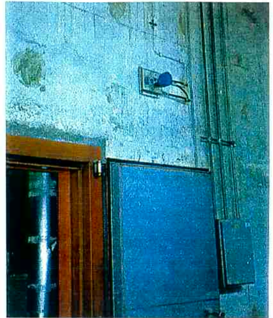
Fig. 4.10 – Medidor mássico de gás combustível, instalado na área de preparação de motores.
