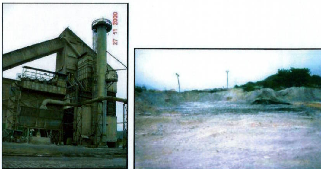
Figura 69 – a) Sistema de filtragem da calcinação #3 (filtros tipo manga) b) Área de disposição de resíduos industriais (cales armazenadas)
