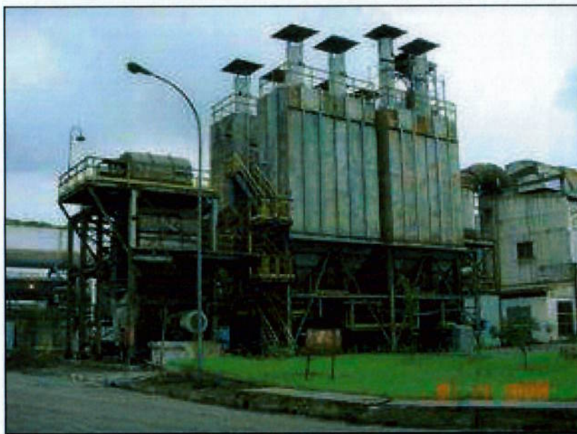
Figura 67 – Sistema de despoeiramento da estação de dessulfuração de gusa da aciaria #2 (mangas filtrantes)
