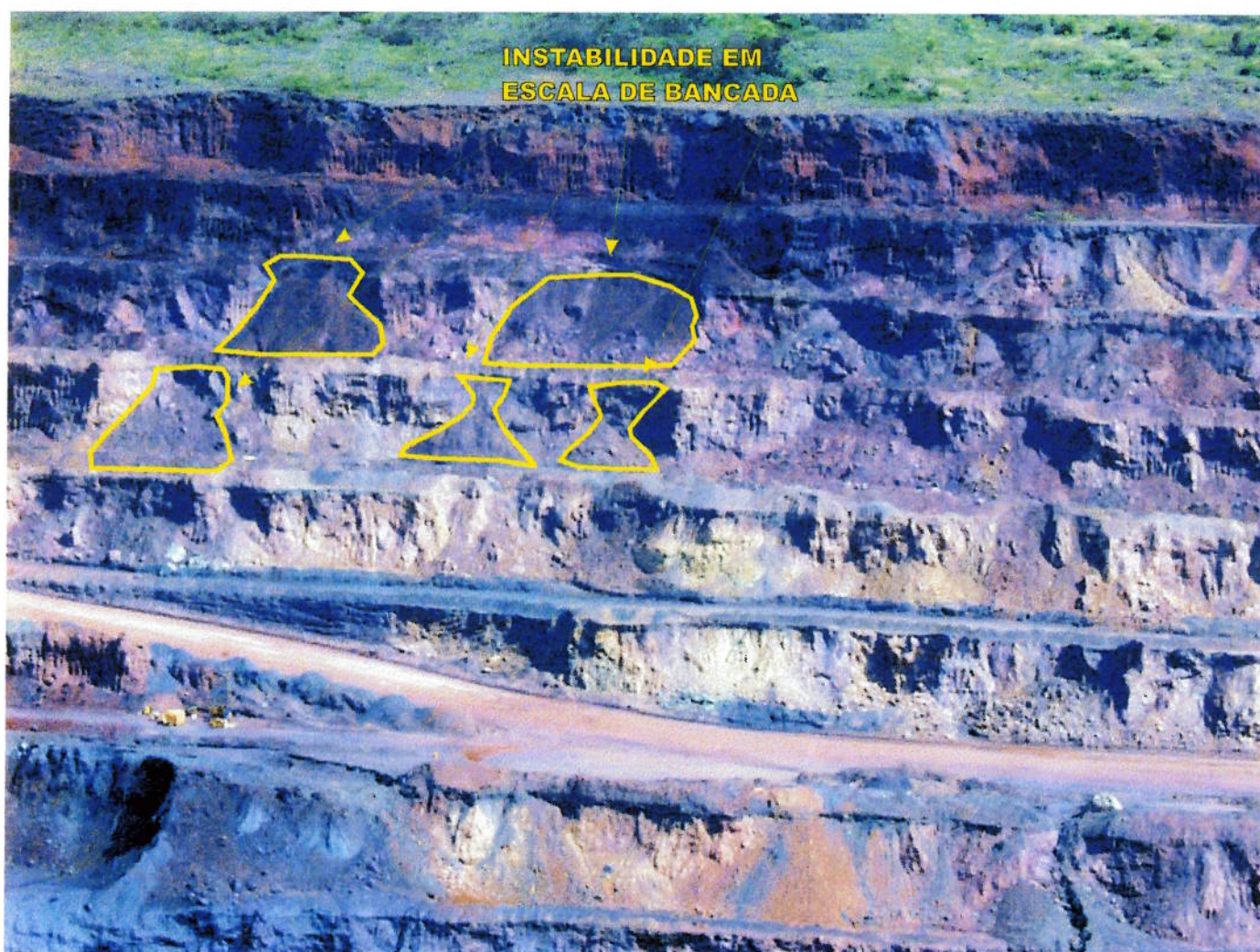
Figura A6.g - Vista em detalhe do Talude Oeste, extremo sul (Seção FG08SE09), da Mina de N4E, com algumas instabilidades em escala de bancada.
