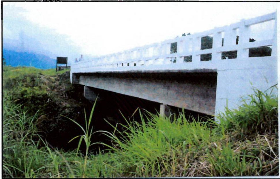
FOTO 8.9 Processo tipo rastejo no talude de encontro da ponte sobre o rio Preto. Observa-se o embarrigamento do talude na parte esquerda da foto, km 349+400.
