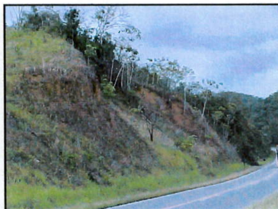
FOTO 8.2 Cicatriz de escorregamento estruturado, km 378+000 LE (Lado esquerdo).
