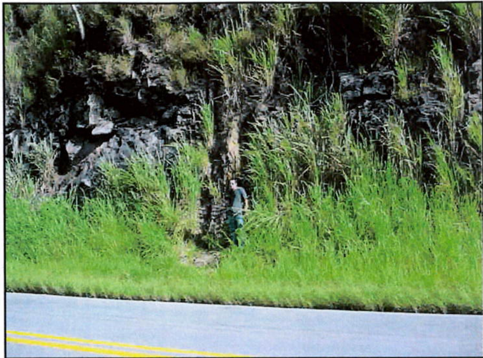
FOTO 8.6 Cicatrizes de escorregamentos estruturados em corte. Observam-se blocos que poderão escorregar devido ao seu isolamento pelas famílias de fraturas.
