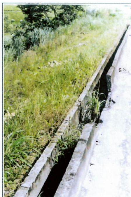
FOTO 7.9 Canaleta retangular de concreto deteriorada junto ao km 385+800,00 (LENC, 2000).
