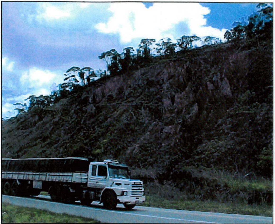
FOTO 8.5 Erosão em ravina e escorregamentos estruturados em corte de elevada inclinação e ausência de drenagem superficial, km 353+250 LE.
