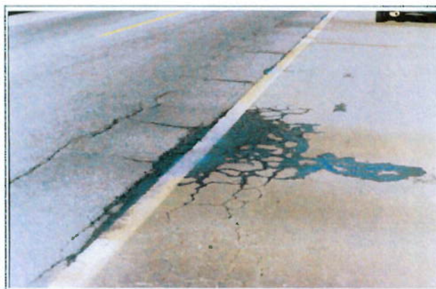
FOTO 7.7 Efeito da ausência de drenos de pavimento (LENC, 2000).
