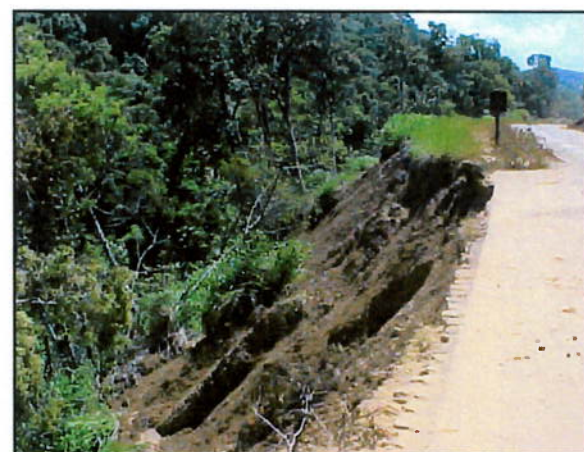
FOTO 1.5 SP-222 – Rodovia José Redis. Local onde ocorreu ruptura do aterro da rodovia. Nota-se que o acostamento ficou seriamente comprometido. A via ficou interditada por cinco horas no dia 21/02/03.
