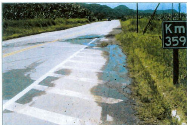
FOTO 7.6 Pavimento implantado sobre um subleito da planície costeira com deficiência no sistema de drenagem (LENC, 2000).
