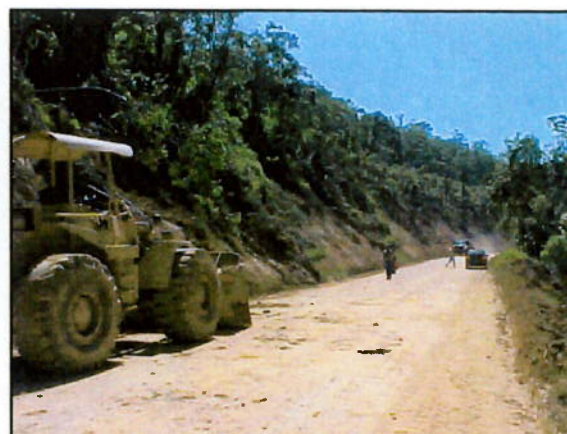
FOTO 1.4 SP-193 – Sem Denominação. Observa-se máquina removendo materiais mobilizados e as cicatrizes de escorregamentos planares. A via ficou interditada por cinco horas no dia 21/02/03.
