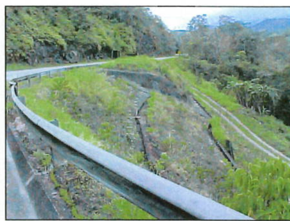
FOTO 8.20 Obra de contenção com canaletas, drenos horizontais profundos e barbacãs, km 379+000 LE.
