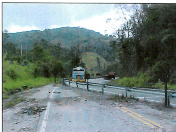
FOTO 8.23 Pista desativada devido à ocorrência de escorregamentos, km 379+500 LE.
