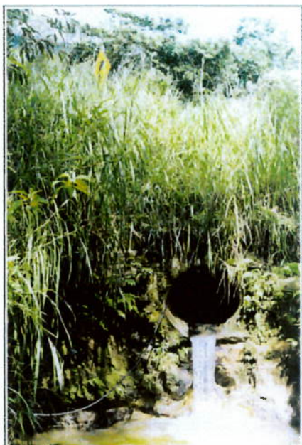
FOTO 7.8 Bueiro tubular simples de concreto no Ribeirão do Alferes (LENC, 2000).
