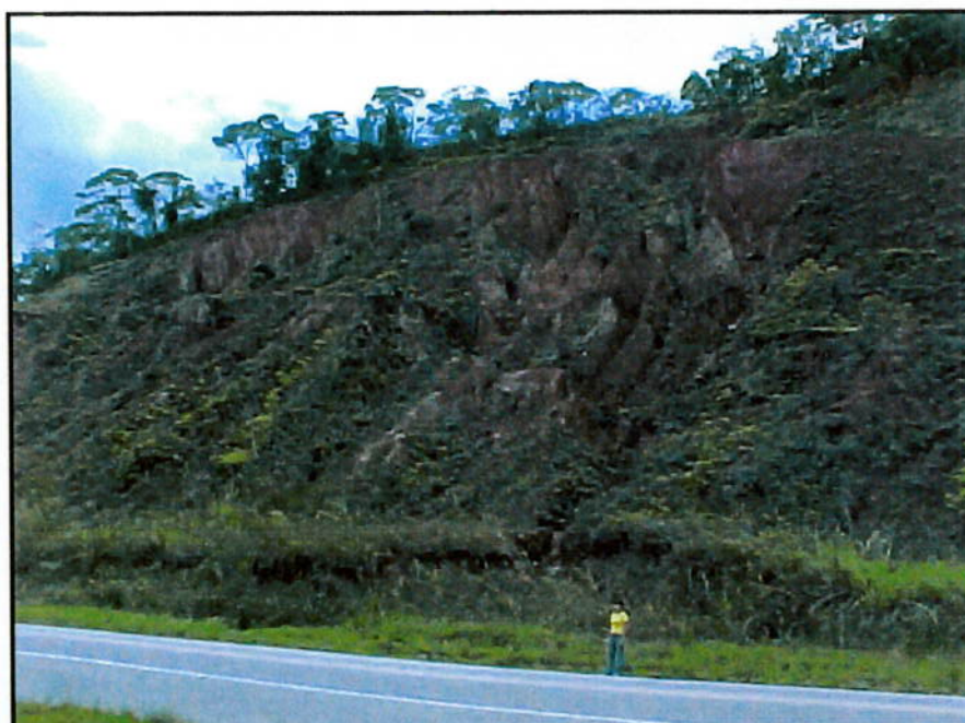
FOTO 7.1 Corte na faixa de domínio onde observam-se cicatrizes de escorregamentos estruturados e focos erosivos.
