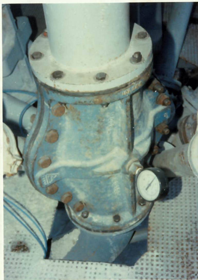
FIGURA 9.11. - TUBULAÇÃO DE DESCARGA DO REJEITO. DETALHE DA VÁLVULA DE CONTROLE DE VAZÃO, QUE É PNEUMÁTICA, DE MANGOTE: FUNCIONA PELO ESVAZIAMENTO OU ENCHIMENTO DA CÂMARA INTERNA DE AR
