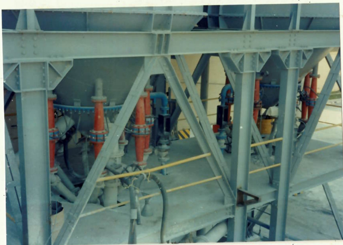
FIGURA 9.6. - CONJUNTOS DE AERAÇÃO DAS DUAS CÉLULAS
