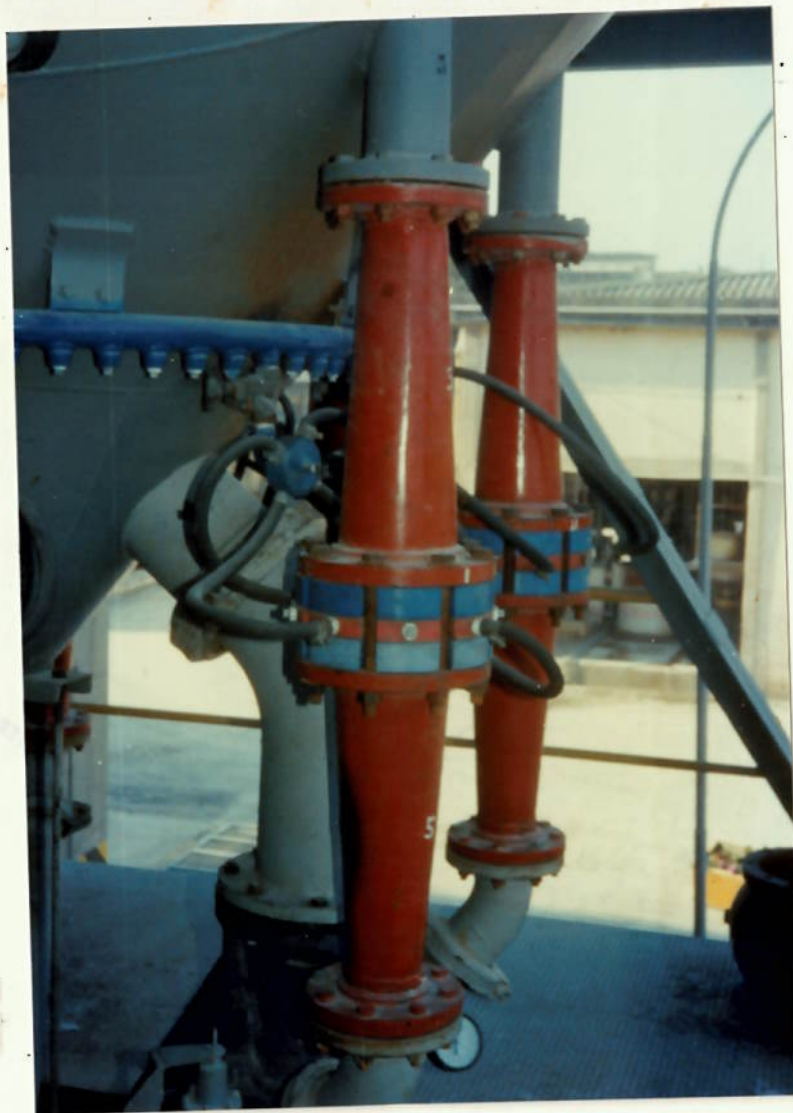
FIGURA 9.7. - DETALHE DOS AERADORES, NOTANDO-SE A DISTRIBUIÇÃO DO AR PARA CADA UMA DAS OITO UNIDADES DE CADA CÉLULA. A POLPA ESTÁ FLUINDO PERPENDICULARMENTE À INJEÇÃO DE AR, DE BAIXO PARA CIMA
