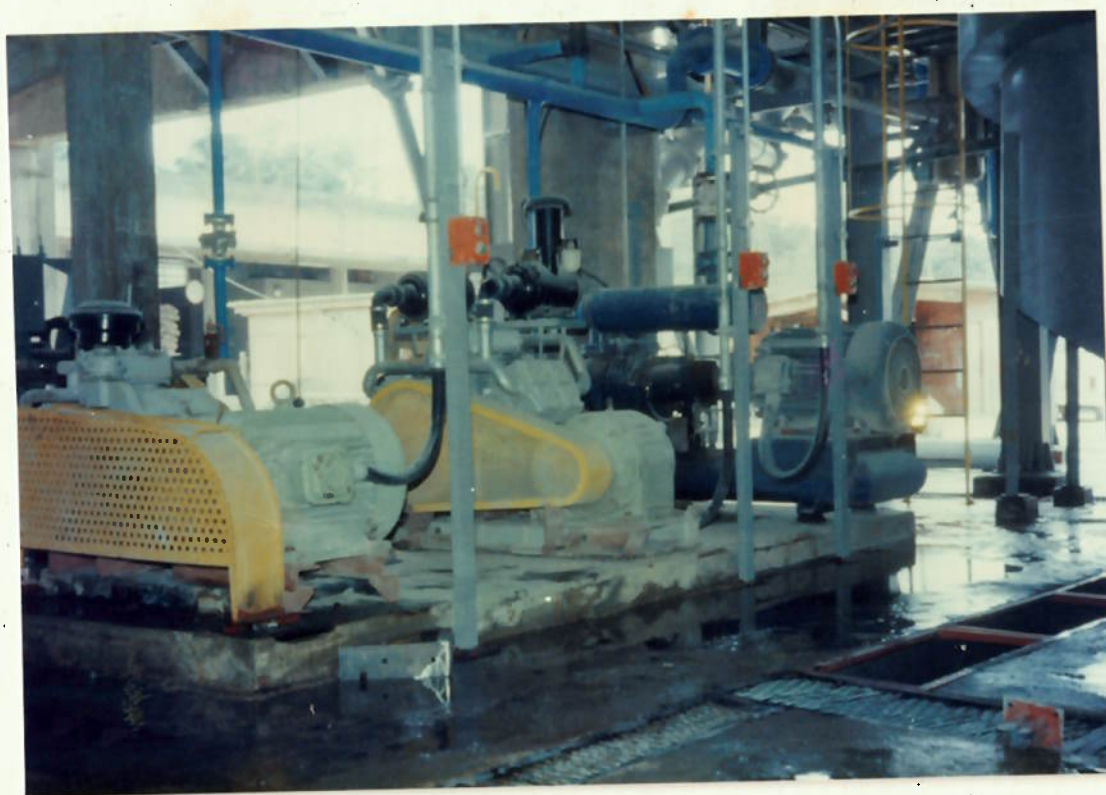
FIGURA 9.15. - SISTEMA DE AR-COMPRESSADO: UM COMPRESSOR DE PARAFUSOS (AO FUNDO), COM SISTEMA RESERVA DE COMPRESSORES DE PISTÃO (EM PRIMEIRO PLANO). A PRESSÃO NECESSÁRIA NÃO PASSA DE 0,1 MPa (1kgf/cm 2 ), CONSIDERANDO ATÉ OS AERADORES, QUE TRABALHAM COM 0,07 A 0,1 MPa (0,7 a 1,0 kgf/cm 2 )
