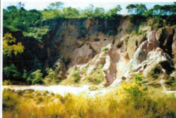
Talude remanescente de lavra que apresenta feições recentes de erosão. Na base dele se localiza o campo de futebol da foto 45-2, de 1997.
