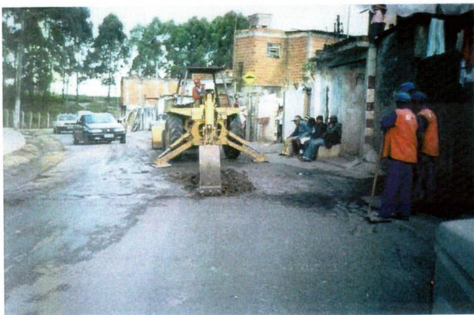
FOTO 07 - Recuperação do pavimento asfáltico nas vias de acesso ao aterro (maio de 2000).
