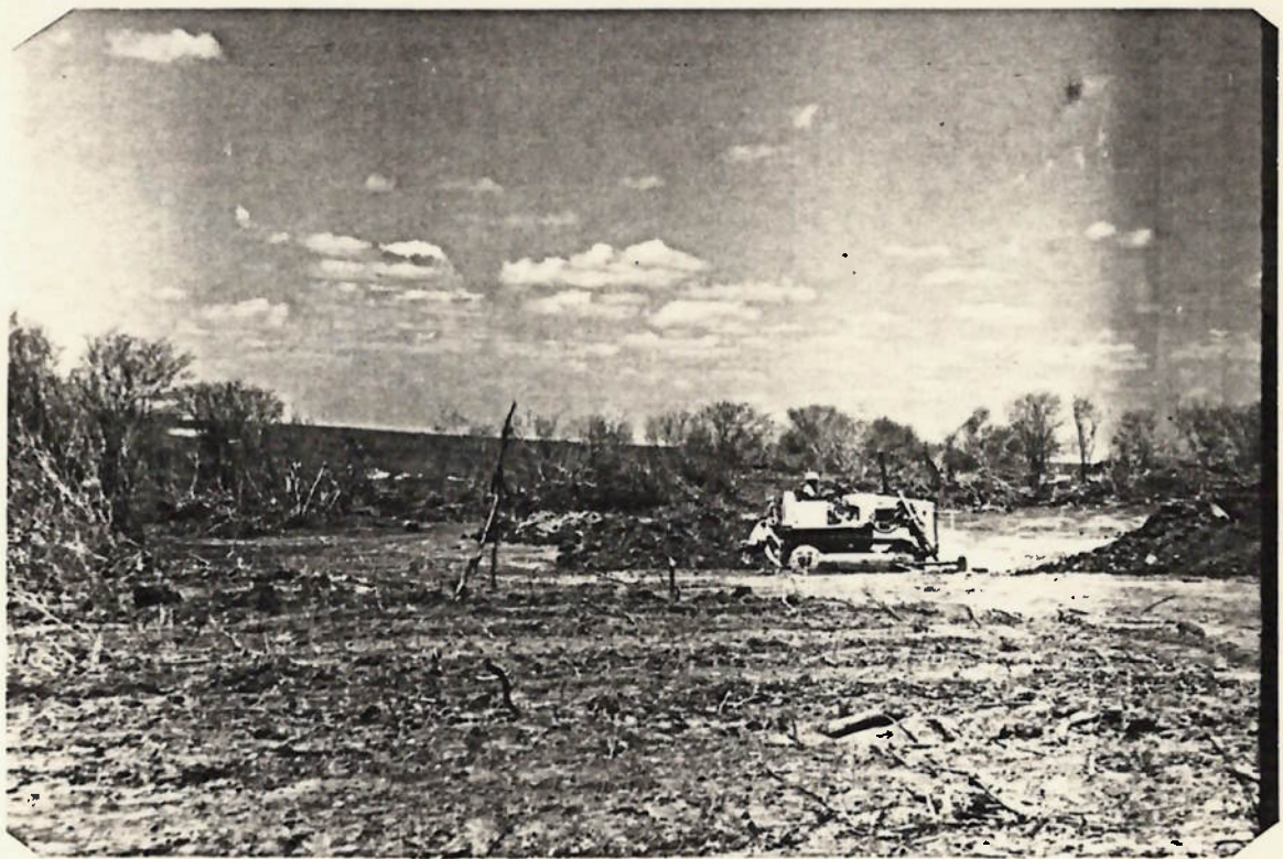
Foto 1.2 - Fase de desmatamento da cobertura vegetal da caatinga visando a preparação da área para a lavra propriamente dita.
