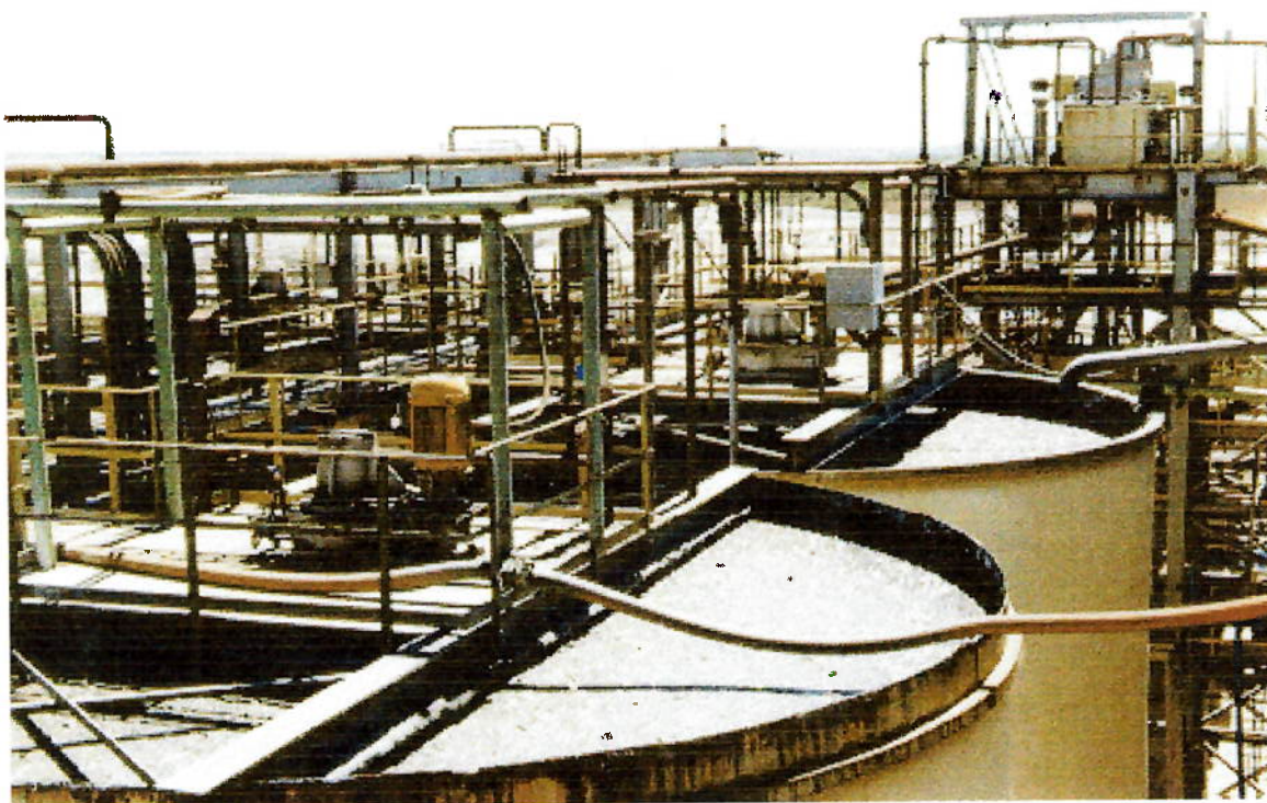
Figura 4.1- Vista dos tanques de lixiviação/adsorção CIL da linha 2 da usina de Fazenda Brasileiro
