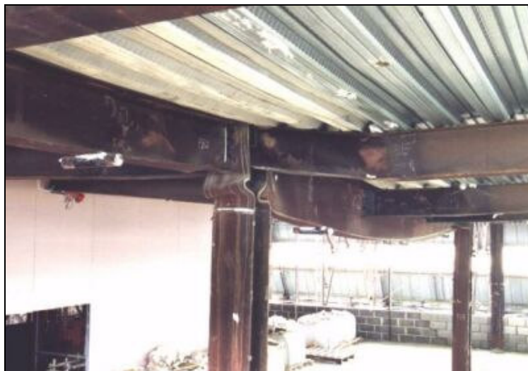
Figura 1-4 - Flambagem local no topo do pilar (Ensaio de Cardington 4 , 1996).
