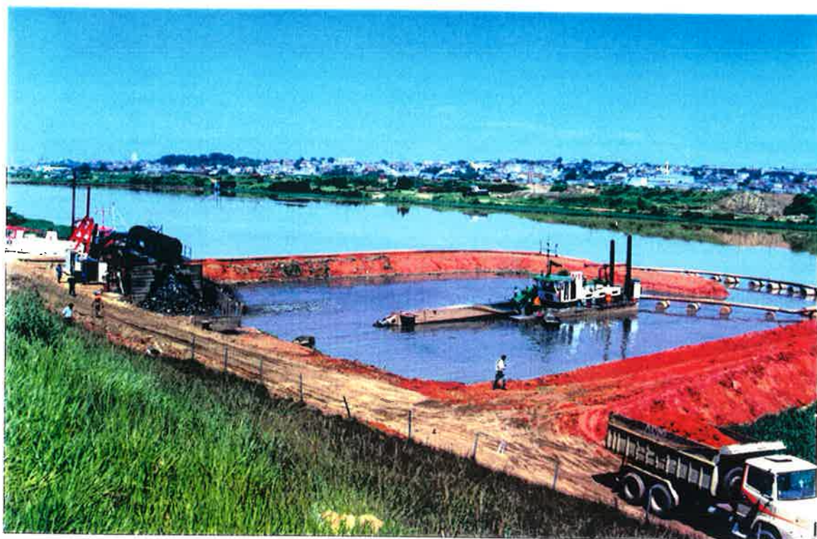
Figura 4.6 - Vista do local de instalação do “trommel”
