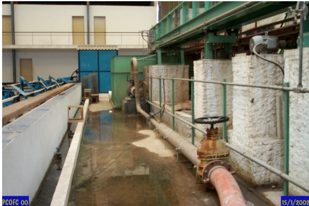
Foto 5: Detalhe do medidor de vazão e registro de controle.
