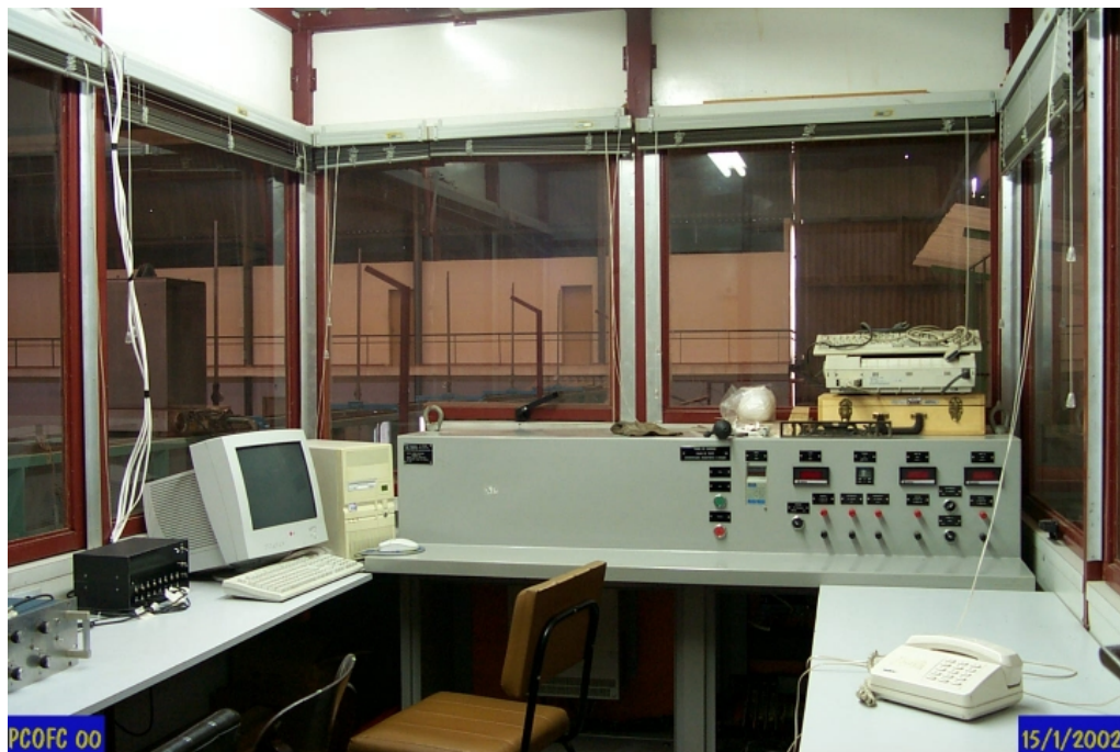
Foto 8: Vista da sala de recepção dos sinais de medição e controle de ensaio.
